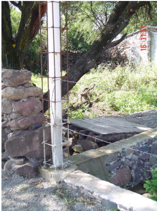
El sistema constructivo de la zona, zapatas corridas a 1.5 m de profundidad y castillos.
