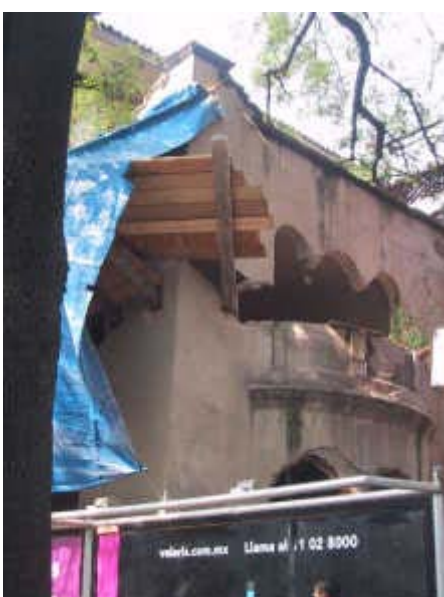
Calle Emilio Castelar No. 195, casa que a pesar de estar catalogada por el Instituto Nacional de Bellas Artes y la Dirección de sitios patrimoniales y Monumentos del D.F., estaba siendo demolida en febrero de 2006.
