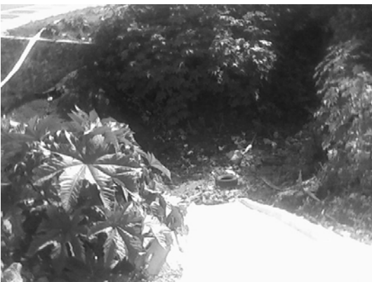
Imagen 32- Demasiada vegetación en alcantarilla Fuente: Propia.
