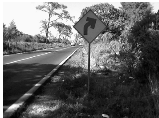
Imagen 33- Demasiada vegetación en cunetas Fuente: Propia.
