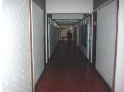
El pasillo que comunica a los cubículos carece de iluminación y ventilación natural.
