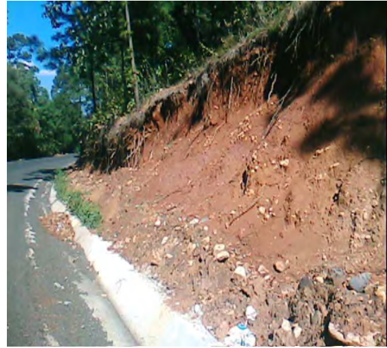
FOTO 4. Falta de mantenimiento.
