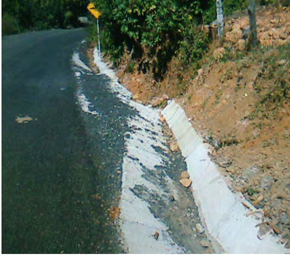
FOTO 3. Asolve de cunetas.
