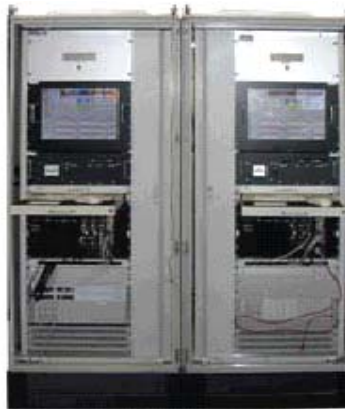
Fig. 2.59. Estación de control maestro.
