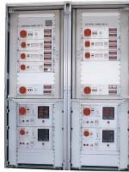
Fig. 2.56. Unidad de potencia eléctrica.
