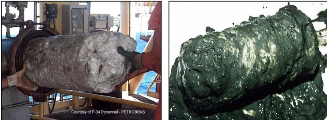
Fig. 1.31. Formaciones de hidratos de metano extraídos de tuberías de producción afectadas.
