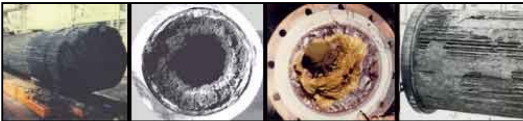
Fig. 1.29. Tuberías obstruidas por asfáltenos.
