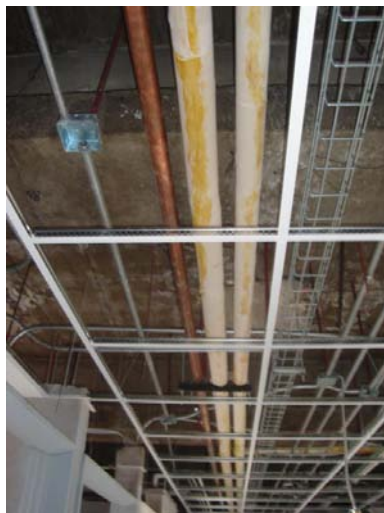
Instalaciones Hidráulicas Alimentaciones de agua Caliente y Retorno
