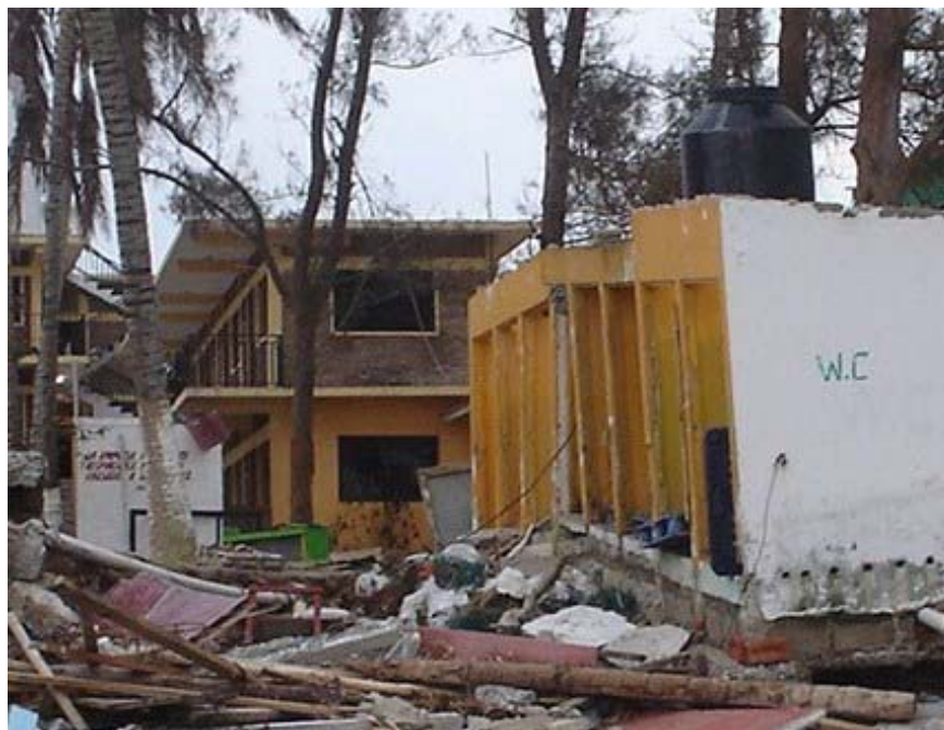
Fig. 3.19. Construcciones derrumbadas al paso del huracán "Dean".
