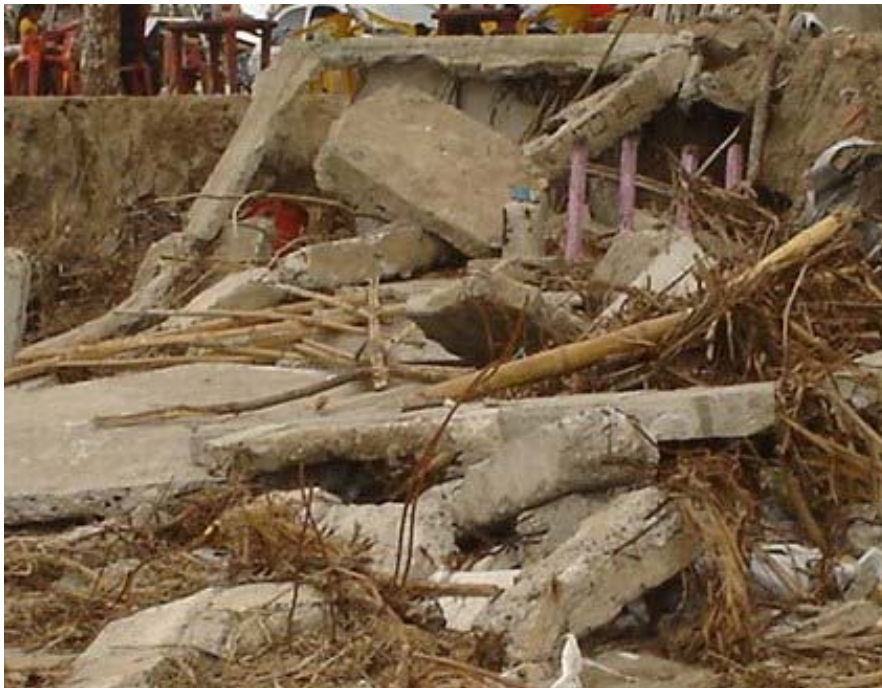
Fig. 3.17. Daños originados por el paso del huracán "Dean".
