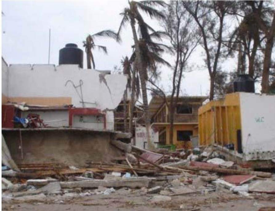
Fig. 3.22. Sanitarios derrumbados después del paso del huracán "Dean".
