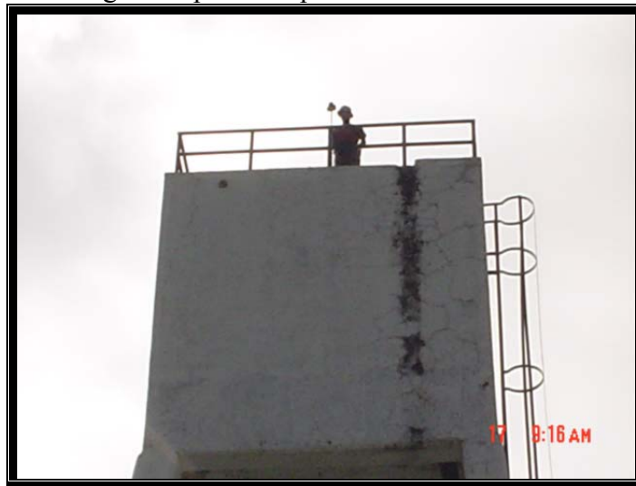
Fig. IV.9. Altura de tanque elevado.
