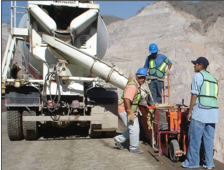
FIGURA II.47 DESCARGA DE CONCRETO A LA MÁQUINA BORDILLERA PARA LA CONSTRUCCIÓN DEL BORDILLO
