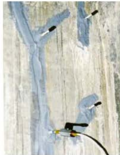
Fig. 5.35 Las fugas en el sellado de la grieta se localizan rápidamente inyectando aire en la grieta (Trout, 2005)
