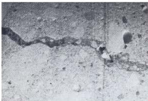
5.4 La resina saturada con detritus dentro de las grietas inyectadas, con frecuencia alcanza las mismas resistencias que el concreto (Trout, 2006)
