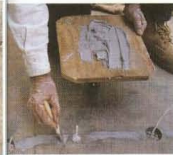
Fig. 5.29 Como preparación para sellar la grieta se aplica una capa de sellador entre puertos (Trout, 2005)
