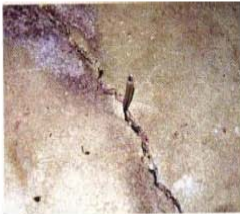
Fig. 5.19 Las grietas mayores que 3 mm de ancho son candidatas para colocarles puertos de inserción (Trout, 2005)
