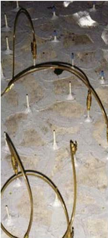
Fig. 5.34 Los puertos múltiples permiten inyectar varios puertos de la misma grieta (Trout, 2005)
