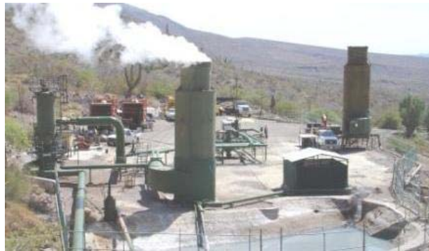
Figura 1.13 Central geotermoeléctrica Las Tres Vírgenes [El autor]
