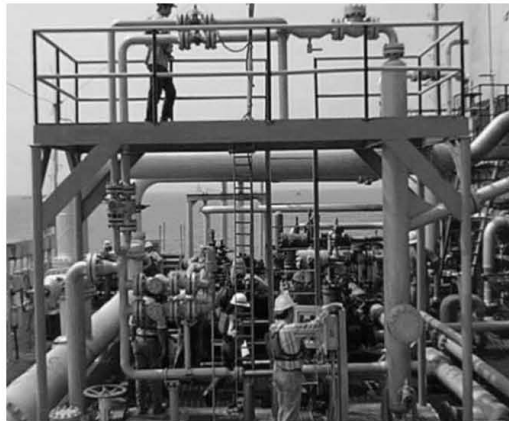
Figura 4.11 Sistema GLCC instalado en el Lago Maracaibo, Venezuela.
