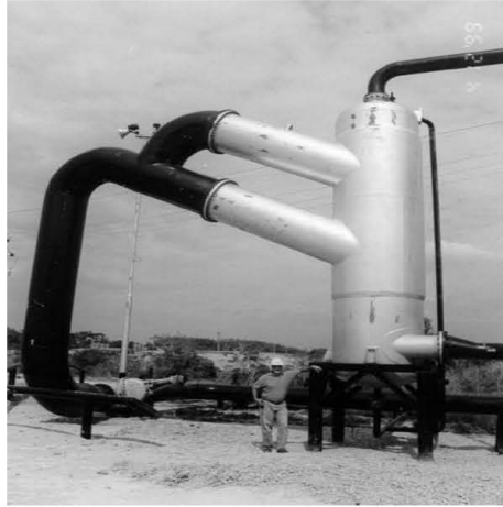
Figura 4.10 Sistema GLCC con slug damper instalado en Minas, Indonesia.
