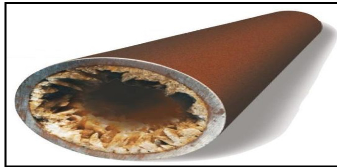
Figura 2.10 Presencia de incrustaciones en una tubería. Ejemplo: En un pozo del campo Millar en el Mar del Norte, los ingenieros se sorprendieron al ver descender la producción de 30.000 Bls/D[4770 m 3 /d] a cero en el lapso de 24 horas. 9
