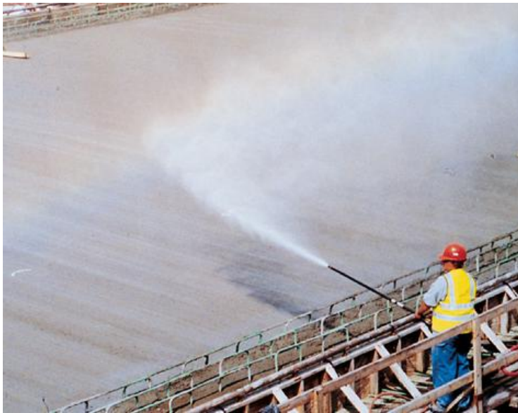
Imagen 5.3 Rociado de agua al concreto para curar manteniendo condiciones de humedad y temperatura adecuadas.
