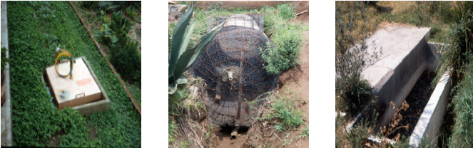
SUTRANE (Sistema unitario de tratamiento de aguas negras). Se compone de: tanque desengrasante, tanque desfosfatante, biodigestor, campo de oxidación y depósito final.
