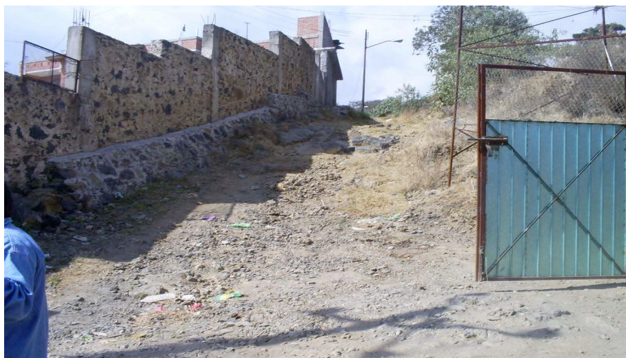
Figura 11.2. En Ixtlahuaca se presentan problemas en predios y calles en época de lluvias debido al escurrimiento.
