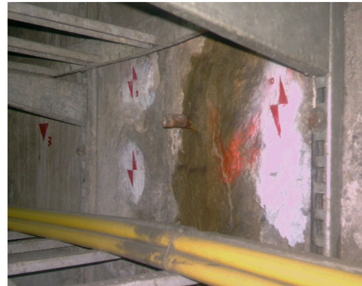
ASPECTO DE UNA FILTRACIÓN EN TUNEL QUE AFECTA LAS INSTALACIONES FIJAS
