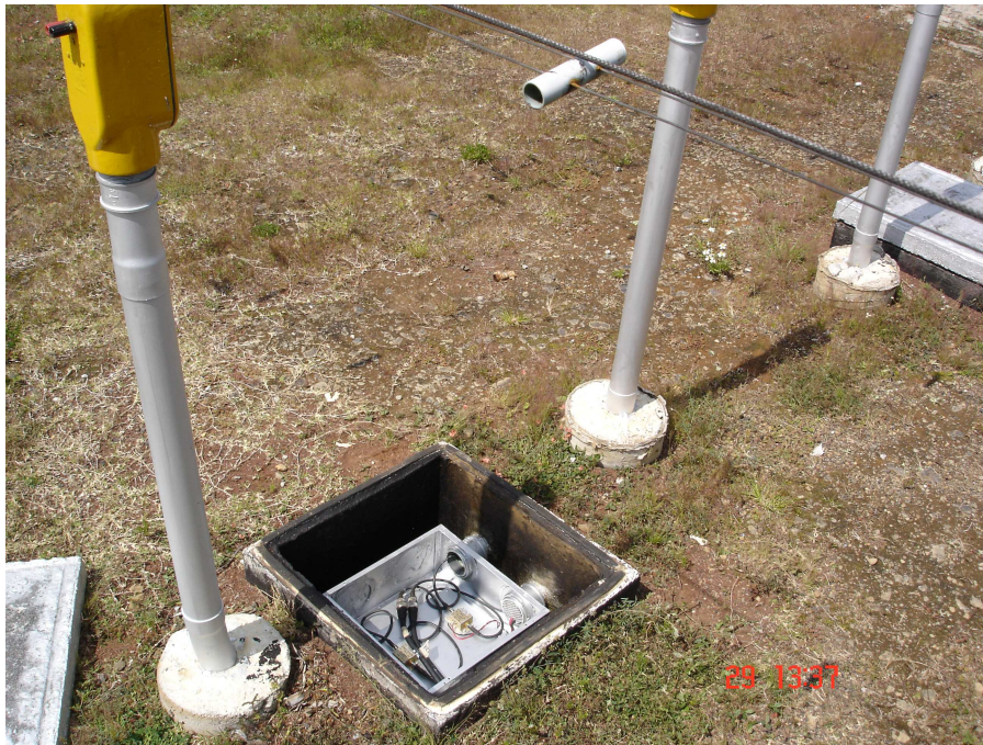
Figura 2.9: Ubicación y entorno de un registro para amplificadores. En la imagen se aprecia la instalación subterránea, la disposición de los ductos que conectan el registro con los balun, etc.
