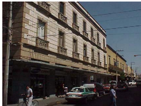
Contaminación con marquesina y cableado
