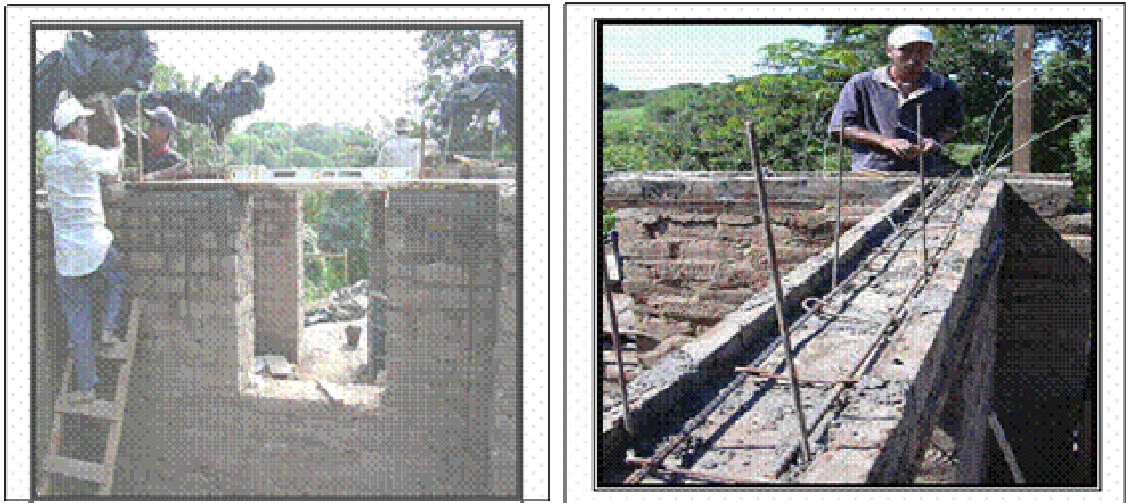
Figura 22.- Construcción de una cadena de cerramiento de Concreto Reforzado en El Salvador (Dowling, 2002)
