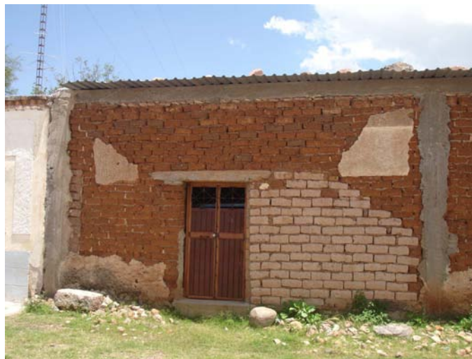
Afectación con castillos y dalas de concreto en muros de adobe*
