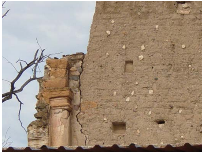
Grieta en la fachada principal de piedra con el muro de adobe, templo de San Francisco
