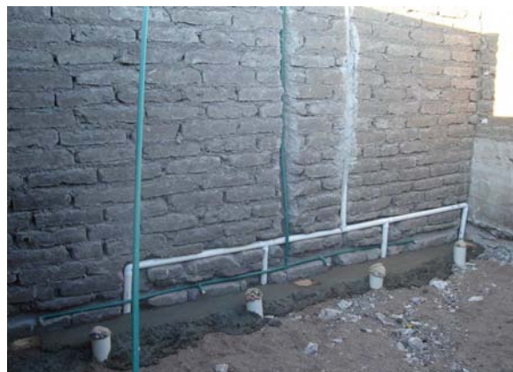
No se debe ranurar el adobe para realizar las instalaciones hidráulica y sanitaria en baños
