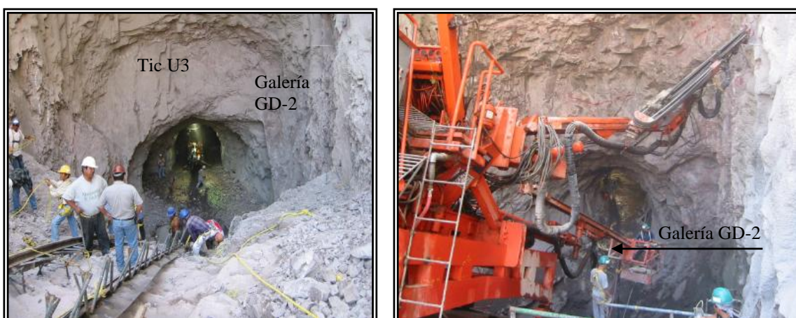
Fotografía 7. Vista de la excavación de las dos tuberías en el codo superior, donde se observan las características de la roca, al fondo en la del lado izquierdo, la galería GD-2
