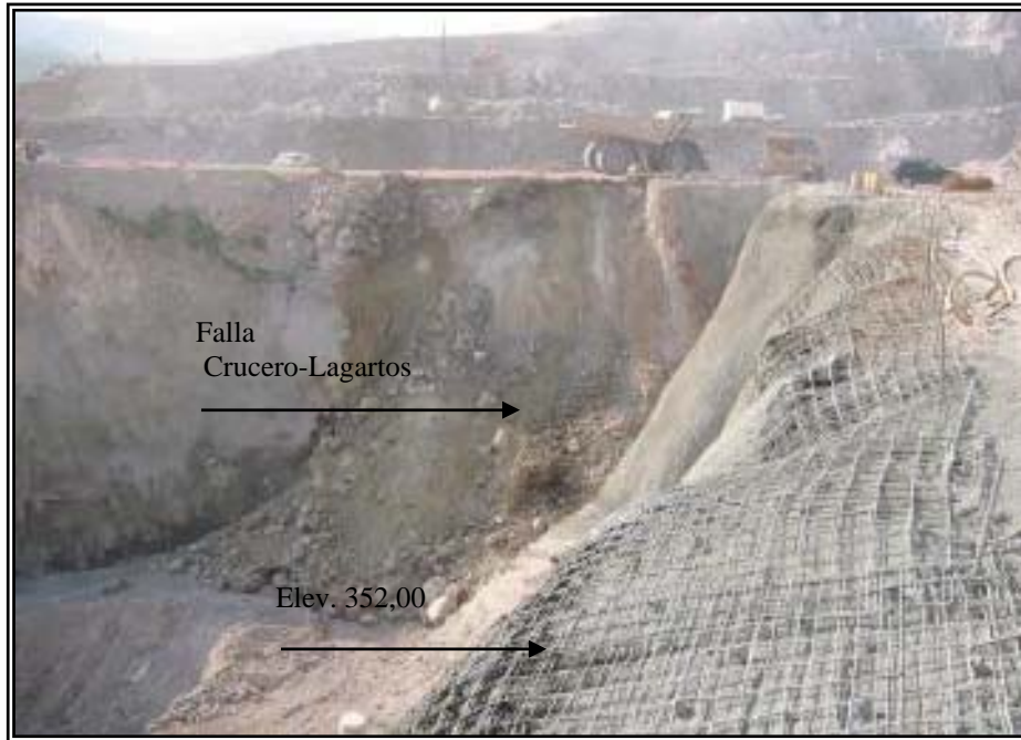
Fotografía 28.- Vista del derrumbe ocurrido en la subestación a la elevación 363,00. Nótese el desprendimiento del material alterado y triturado formado por la convergencia de las fallas Crucero-Lagartos y Fd3 (falla cañada de los diques).
