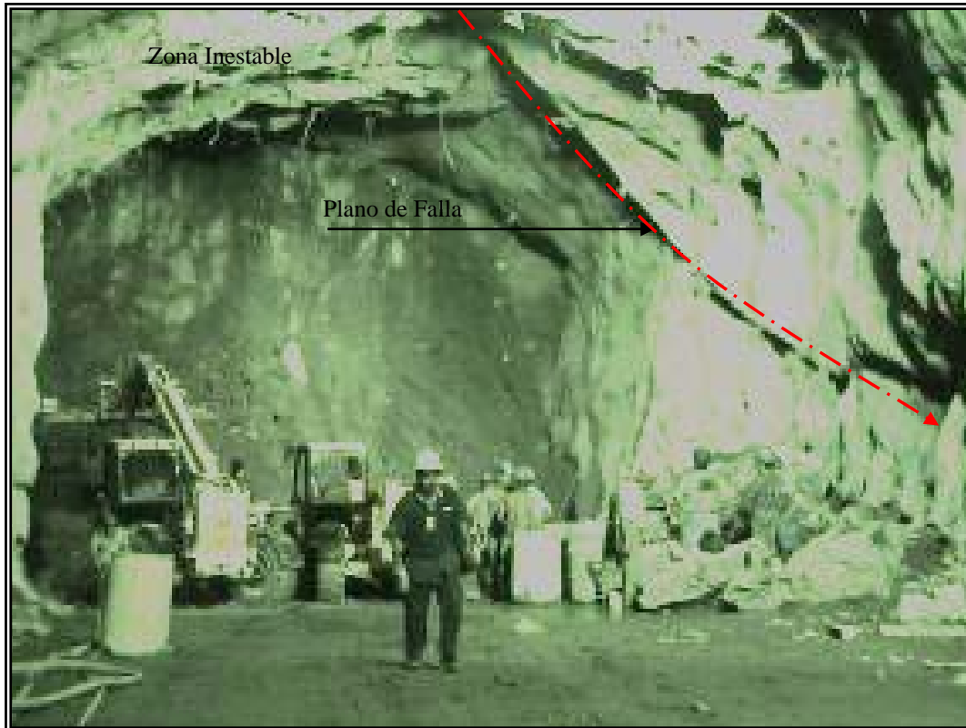
Fotografía 6. Túnel auxiliar de construcción donde se observa el plano de falla en la bóveda orientado a rumbo del túnel provocando la formación de una cuña potencialmente inestable
