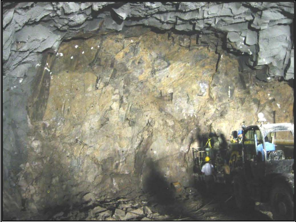
Fotografía 21.- Vista del tope del túnel de desfogue en el cadenamiento 0+231,00, obsérvese el color café claro que muestra la arcilla que rellena las fracturas, con espesores de 5 a 10 cm.
