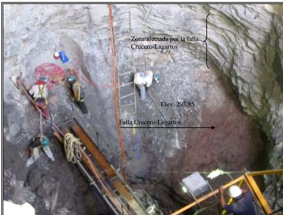
Fotografía 10. Vista de la excavación de la tubería a presión 2 (tramo inclinado) a la elevación 293,85, nótese la mala calidad de la roca, alterada y muy fracturada, en el piso aflora uno de los planos de la falla Crucero-Lagartos
