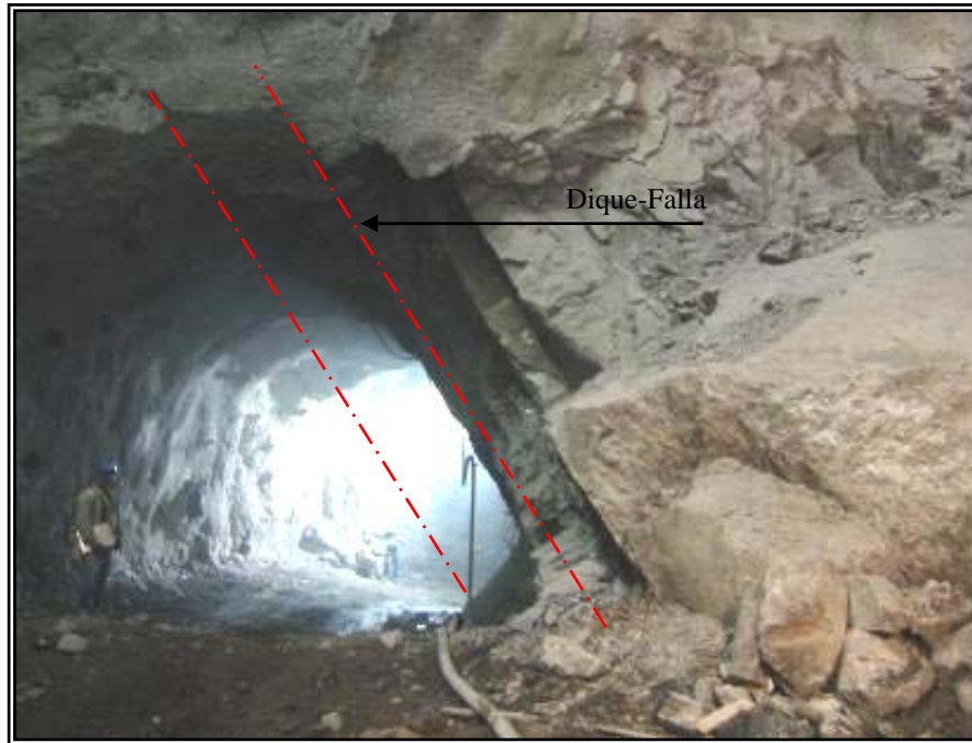
Fotografía 12. Parte más baja del tímpano norte de casa de máquinas donde se aprecia el dique-falla donde presentó condiciones inestables
