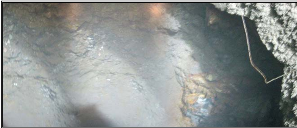
Fotografía 22.- Vista de una de las paredes de la lumbrera de cables a la elevación 280,00, en donde se muestra parte de la zona de Falla Crucero- Lagartos y un dique alterados que provocó un derrumbe formándose esta sobre-excavación.
