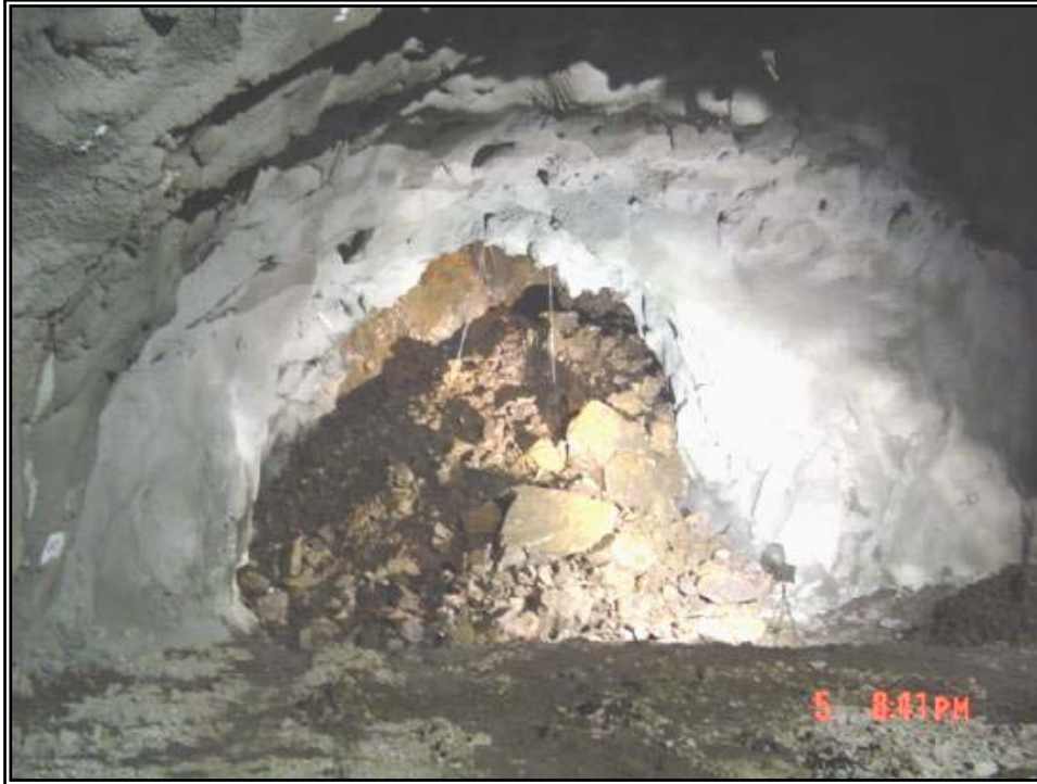
Fotografía 20.- vista del derrumbe en el cadenamiento 0+132,00 del túnel de desfogue, donde las condiciones geológicas provocaron la inestabilidad por la presencia de la falla Crucero-Lagartos.
