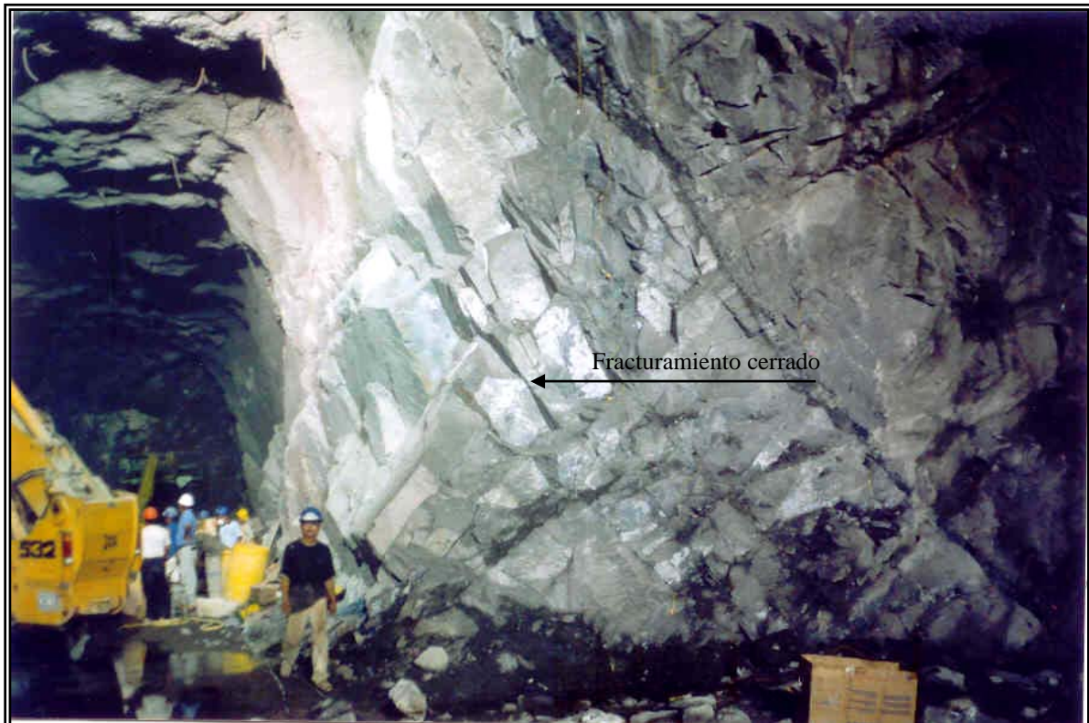
Fotografía 14. Pared de aguas arriba de la casa de máquinas, nótese el fracturamiento cerrado y continuo característico de esta zona
