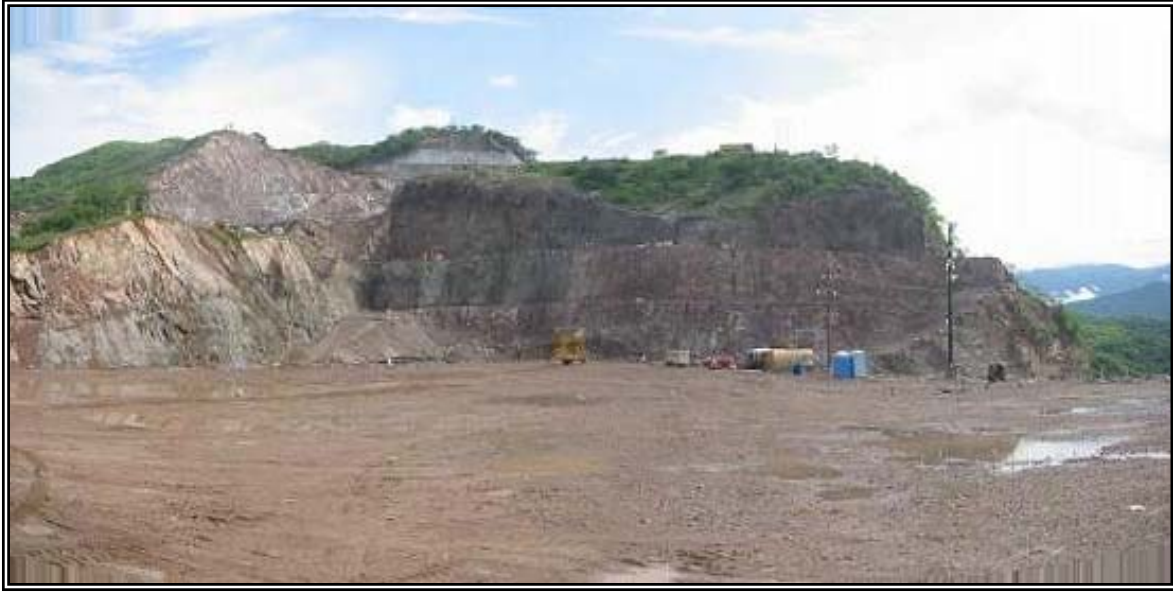
Fotografía 24.- Excavación de la plataforma de la subestación, en el lado izquierdo el talud NW que separa del canal de descarga, en el centro los taludes NE que la separan de la obra de toma.
