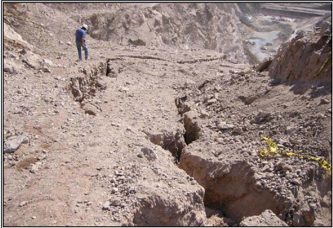
Fotografía 26.- Grietas de tensión generadas por el derrumbe en la zona de la subestación provocadas por la Falla Lagartija SE.
