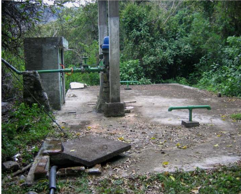
FIGURA No. 11 Tanque de almacenamiento, bomba de 45hp, Cuarto de control del sistema
