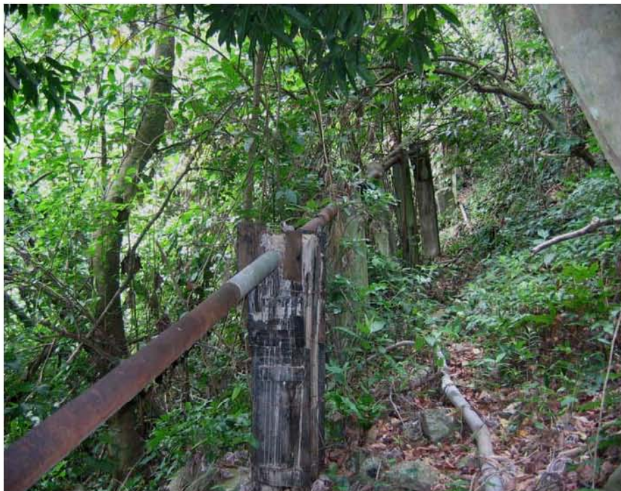
FIGURA No. 4 Tubería de 4" que alimenta al ariete principal
