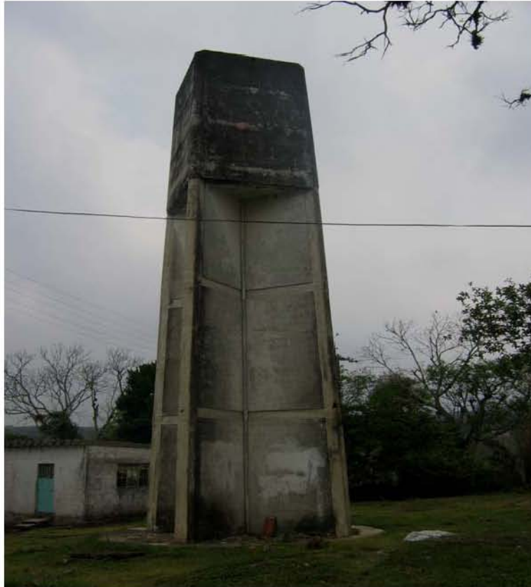
FIGURA No. 6 Tanque elevado actualmente en desuso por falta de mantenimiento
