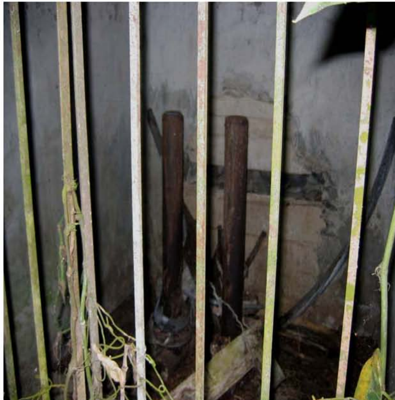
FIGURA No. 5 Arietes en desuso por falta de recursos económicos para darle mantenimiento al sistema
