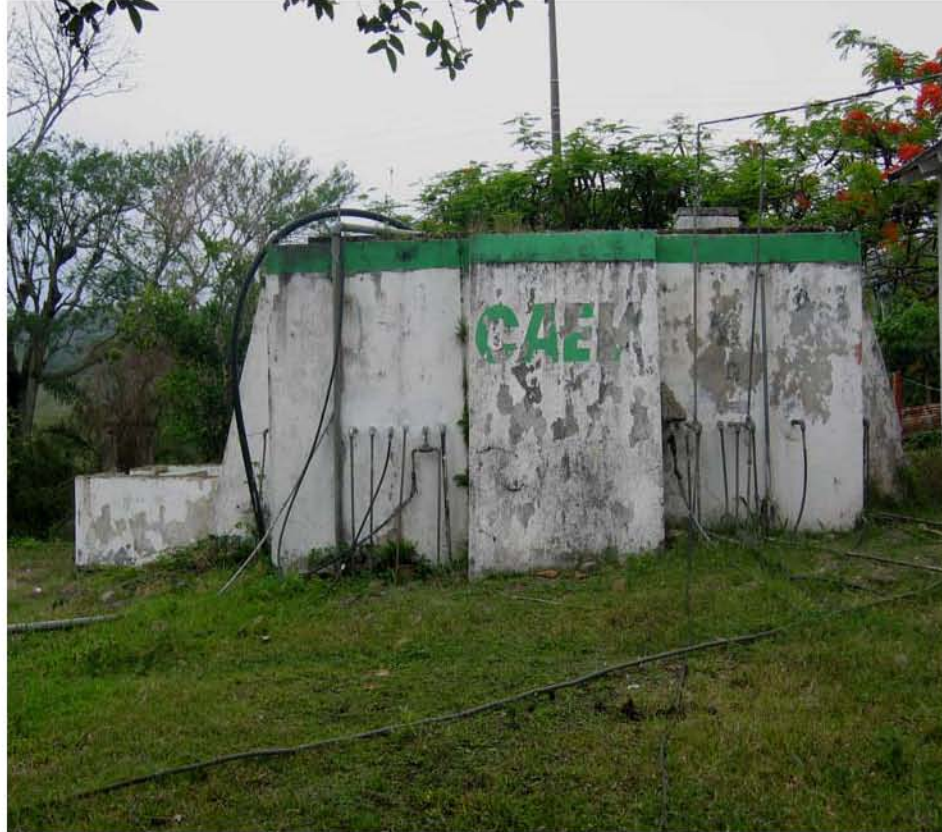
FIGURA No. 7 Depósito con que cuenta actualmente esta localidad el cual como se puede apreciar está en muy mal estado
