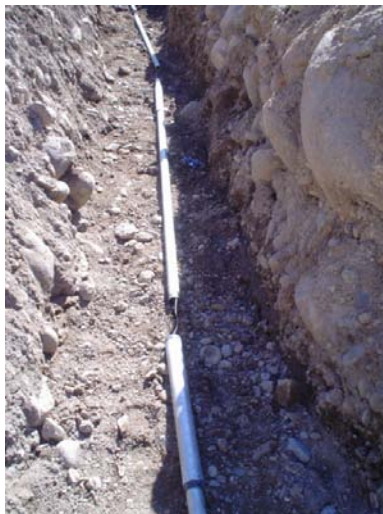
Figura 3.2-3. Tubería de protección para los cables de los aparatos.
