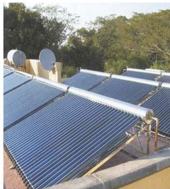
Colector solar Foto: desconocido
