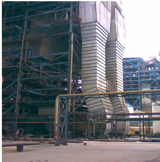
Figura. 3.1 Operación de los ventiladores
