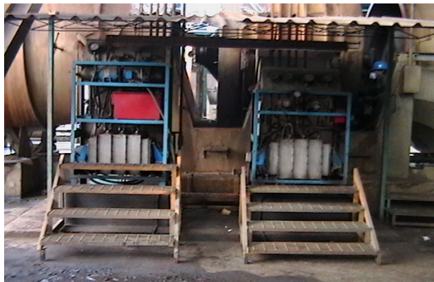
Figura. 5.4 Estación de control
