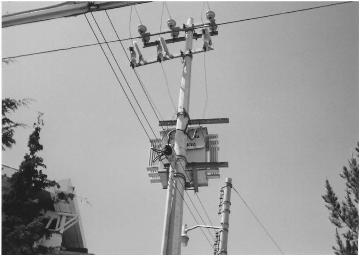
Transformador tipo poste
