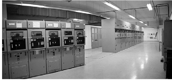
Fig. 11 “Subestación eléctrica tipo gabinete”
