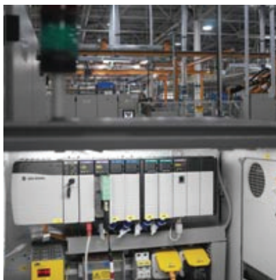
Figura 3-38: Gabinete de control en las instalaciones de Spartanburg
