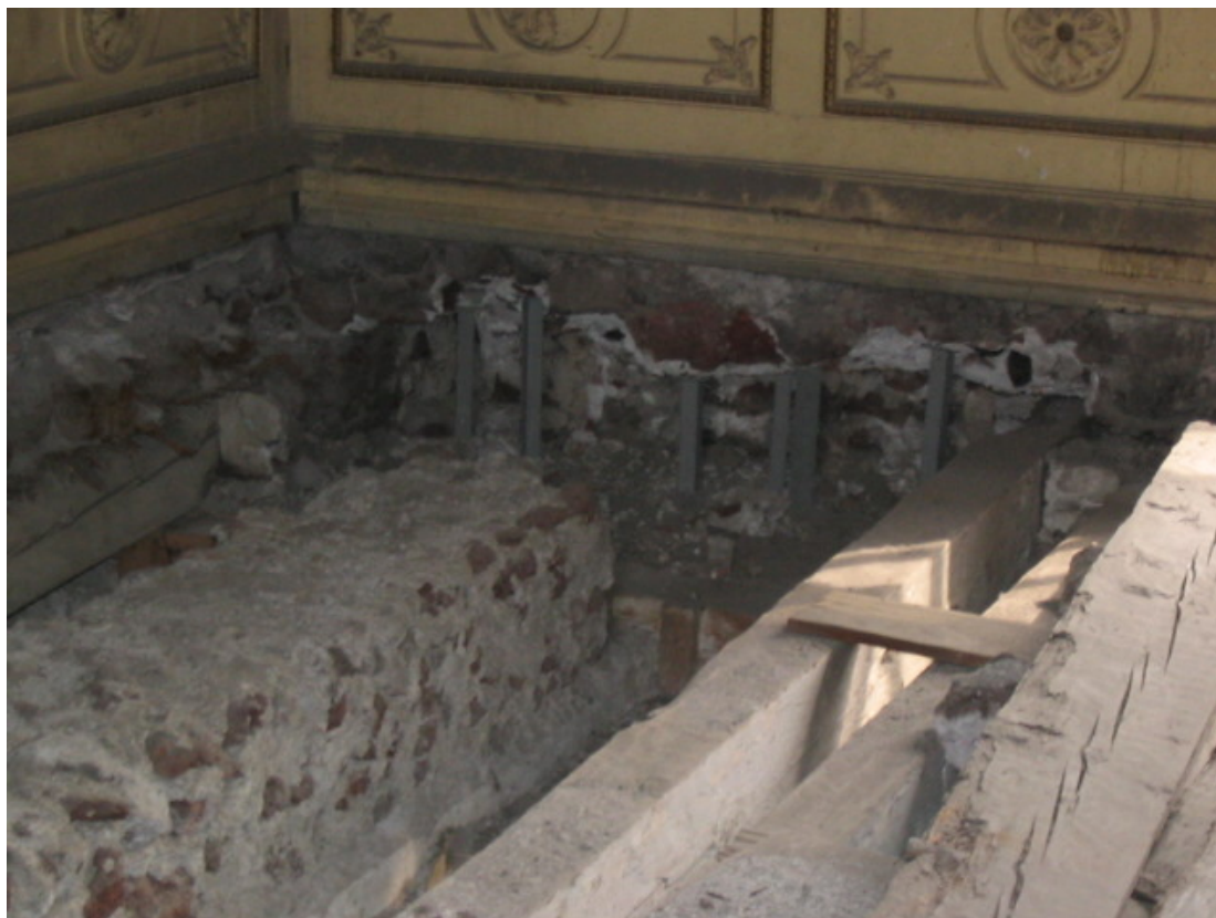
Figura A2.14. Aspecto de muros de mampostería en la unión de los elementos verticales con los horizontales (muro – losa), que ejemplifica claramente el trabajo estructural de este tipo de construcciones. Fuente propia.
