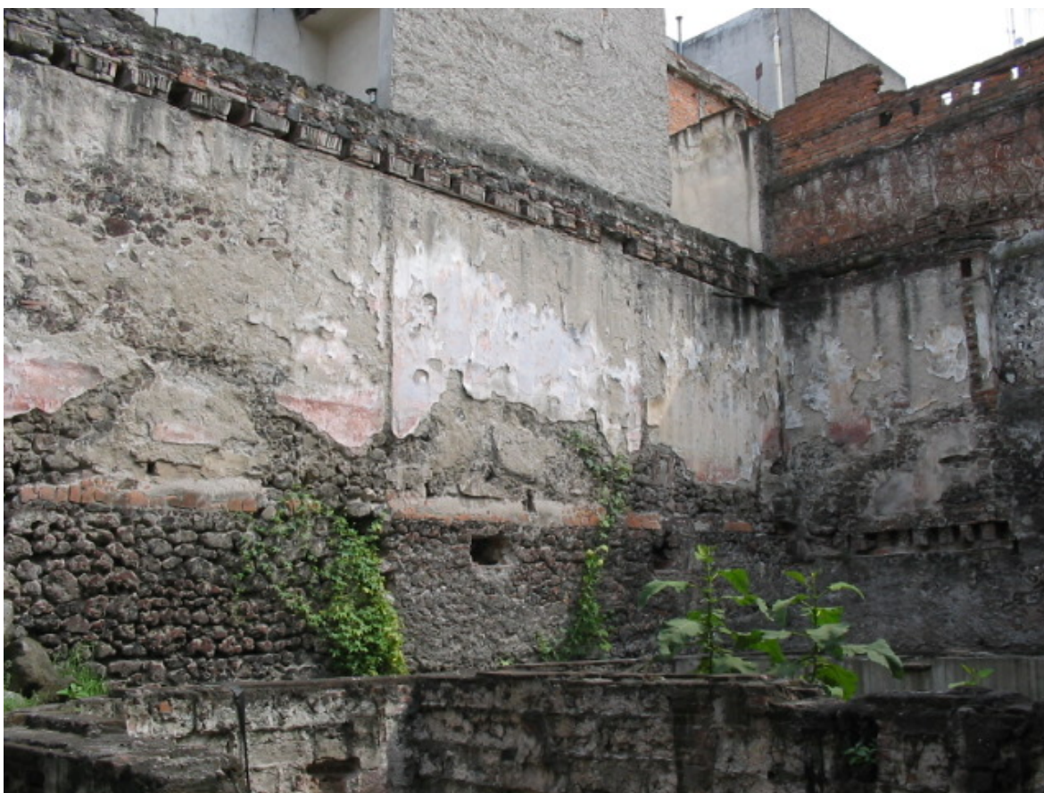
Figura A2.24. Parte de la construcción del Palacio de la Medicina, que dado el abandono ha sufrido mayores deterioros en su estructura. Fuente propia.
