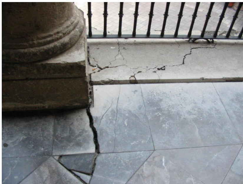
Fig. 1.2 Edificio del Antiguo Palacio de Medicina. Daños en los pisos del primer nivel, donde se presentan agrietamientos fuertes. Fuente propia.
