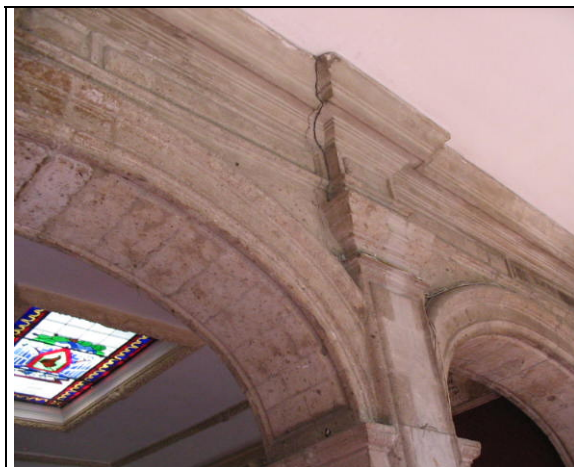
Detalle de grietas en el remate de columna.
