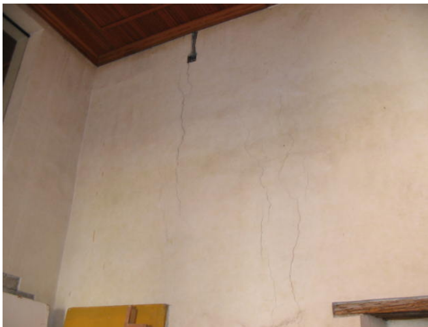
Figura A2.8. Falla en muros de mampostería, debido a hundimientos. Fuente propia.
