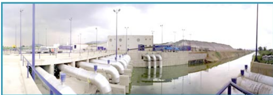
Figura A1.22. Fotografía de la nueva planta de bombeo Gran Canal (Km 18+500), construida en el año 2001, con capacidad para desalviar 42 m 3 /seg. Foto: Secretaría de Obras y Servicios del D.F.
