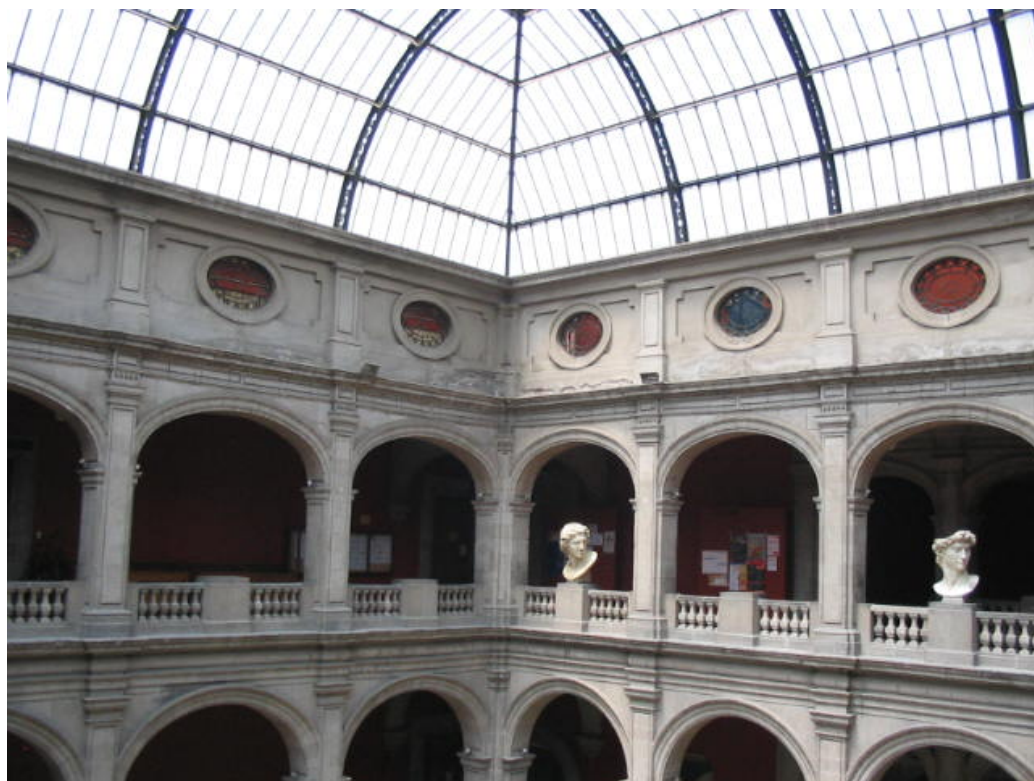
Fig. 3.10. En el edificio de San Carlos no se ha trabajado mucho en los agrietamientos ya que las tendencias de hundimiento son bajas y no se presenta riesgo latente.
