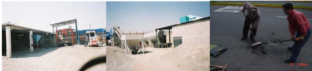
Figura 18 Planta de mezcla asfáltica en frío con asfalto modificado con polímero nova asfalto, no- bache ubicada en Calle Latamex N.1 colonia santa Bárbara centro Iztapaluca estado de México.
