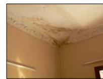
humedad en plafón
