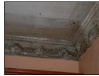
molduras y cielo raso dañados
