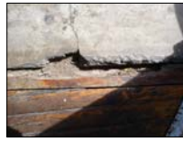
duela de madera dañada
