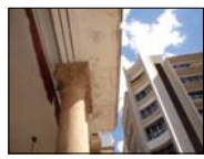
humedad en plátón
