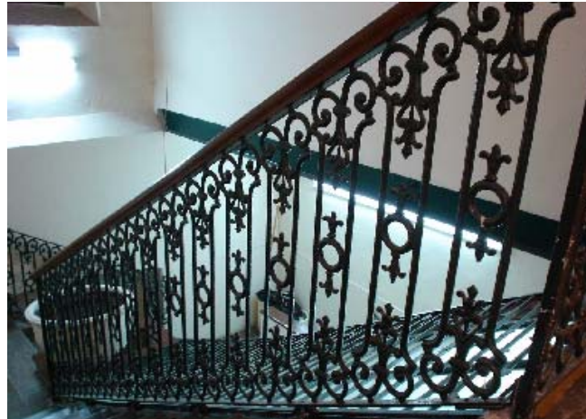
Herrería original de fierro colado de la escalera del departamento con el no. 3. Fotografía actual.
