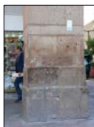
exfoliación y grietas en columna de cantera
