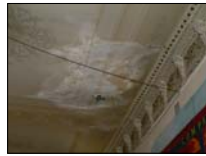
humedad en cielo raso
