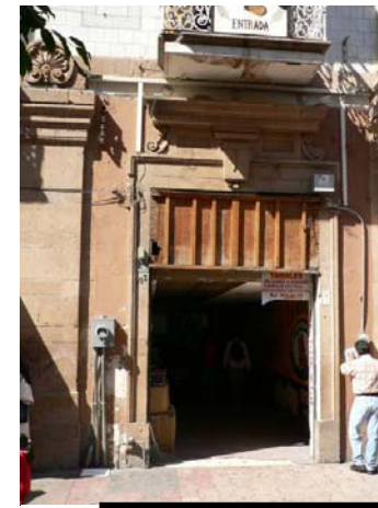
Diversas instalaciones colocadas en ambas fachadas que provocan daños en la cantera.
