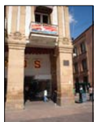
exfoliación en columnas de cantera
