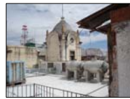
ductos de aire acondicionado
