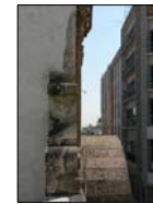
desprendimiento de aplastado
