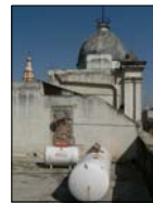
tanques de gas en azotea
