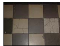
grietas en pisos
