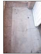
grietas en piso de cemento y exfoliación de cantera
