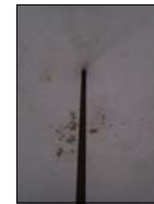
humedades en plátón de torreón
