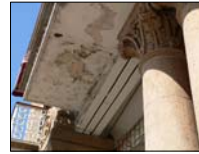
desprendimiento de aplinado
