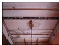
pérdida de cielo raso
