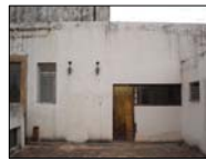
humedades en muros
