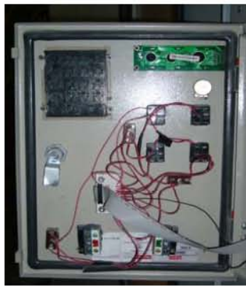
Figura 6.7 Conexiones del control manual
