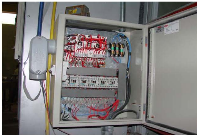
Figura 4.18 Gabinete de potencia
