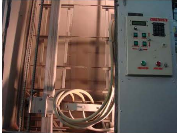
Figura 2.2 Puerta de la cabina
