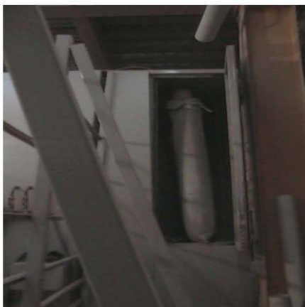
Figura 2.7 Cabina y filtro de polvos
