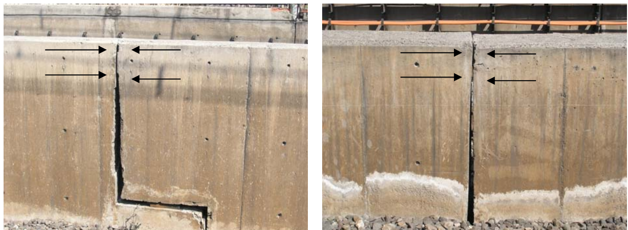
Figura 3.8 Falla por compresión del patín superior, junta expansiva (foto izquierda, cadenamiento 18+680) y de construcción (foto derecha, cadenamiento 19+035)
