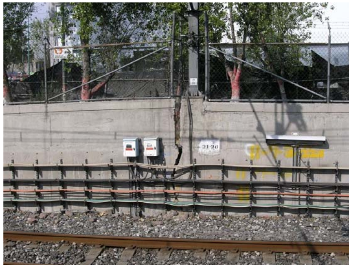
Figura 3.15 Falla por tensión momento negativo (cadenamiento 21+355), la fuerza que puede desarrollar el área de acero es pequeña comparada con la que puede generar la losa de cimentación, el acero fluirá y llegar a su ruptura antes que el concreto se aplaste
