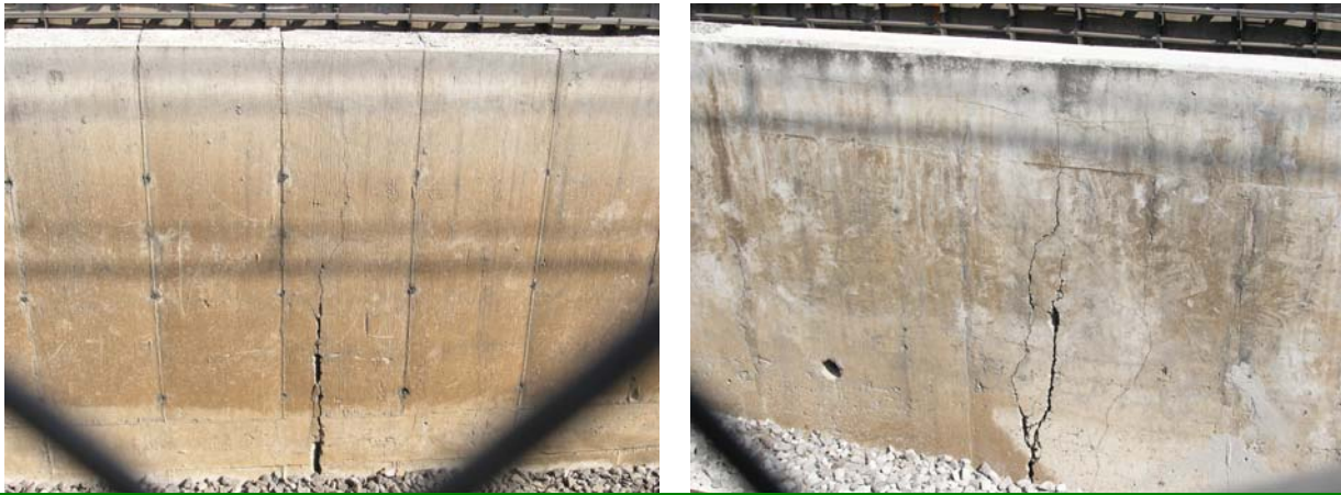
Figura 3.19 Falla por compresión en los muros del cajón del metro, (cadenamiento 17+143)
