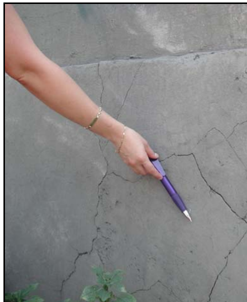
Figura 5.4 se muestra el agrietamiento, generado por la flexión, que presenta los muros laterales cadenamiento 16+284
