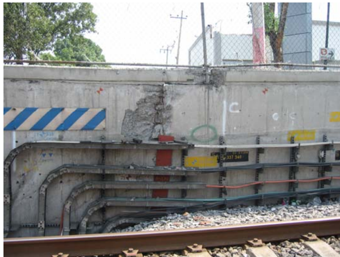
Figura 5.10 Se muestra el agrietamiento que presenta los muros laterales cadenamiento 21+335
