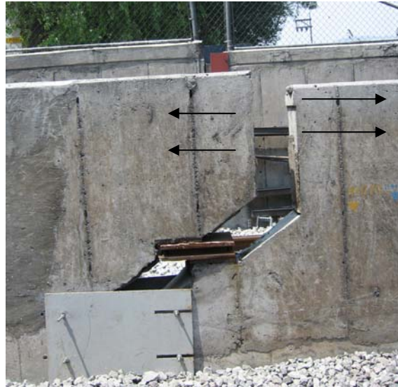
Figura 3.10 Falla por separación del patín superior, junta expansiva (cadenamiento 22+250)
