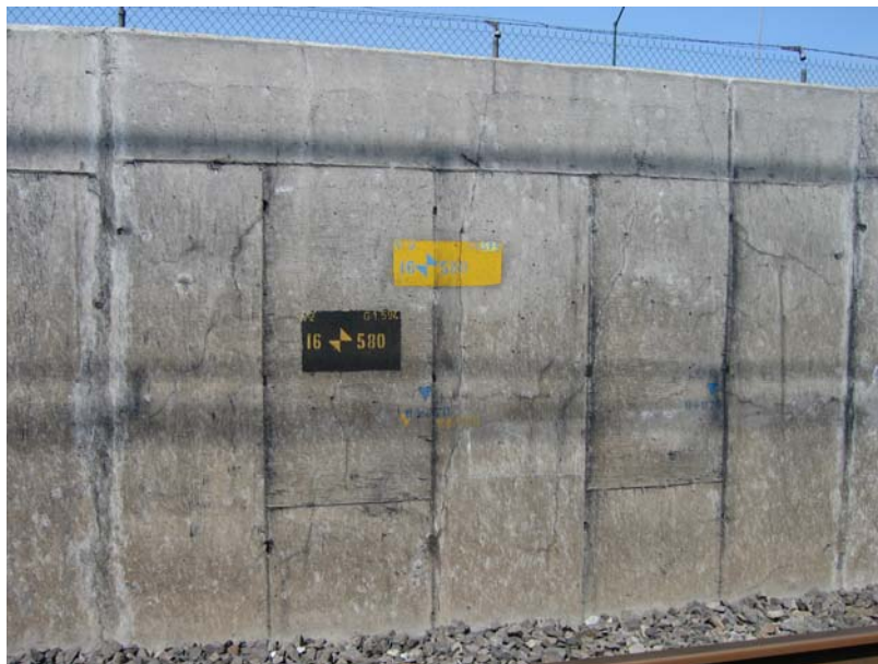
Figura 5.6 se muestra el agrietamiento que presenta los muros laterales cadenamiento 16+580
