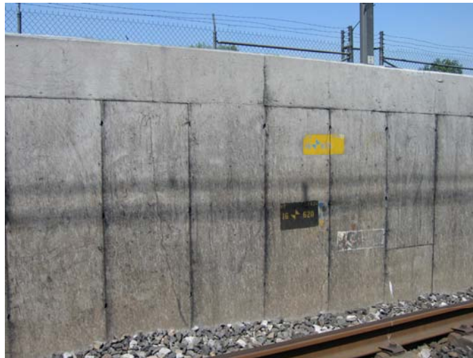
Figura 5.7 se muestra el agrietamiento que presenta los muros laterales cadenamiento 16+620
