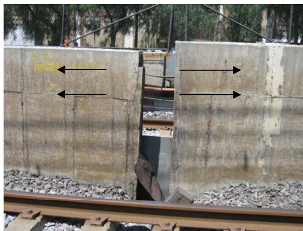
Figura 3.13 Falla a tensión de la losa (cadenamiento 17+495)
