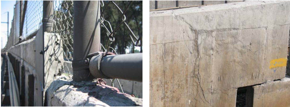
Figura 3.14 Falla por desplazamientos verticales
