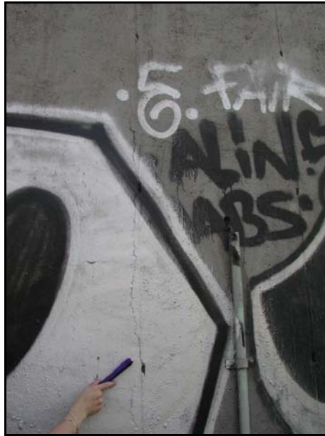
Figura 5.5 se muestra el agrietamiento que presenta los muros laterales cadenamiento 16+556
