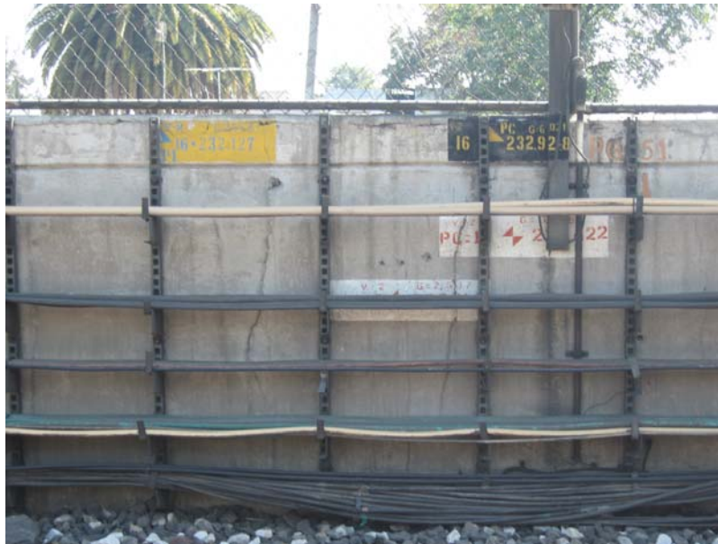
Figura 5.2 se muestra el agrietamiento, generado por la flexión, que presenta los muros laterales cadenamiento 16+232
