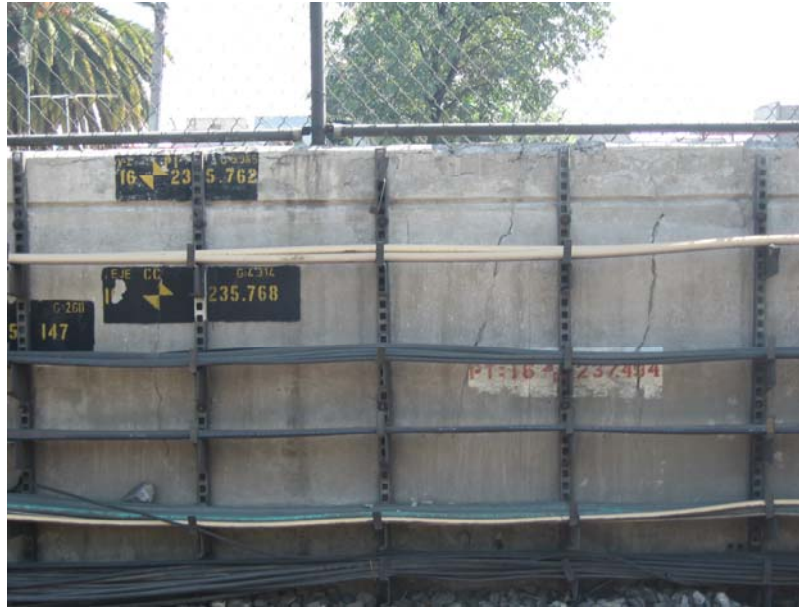
Figura 5.3 se muestra el agrietamiento, generado por la flexión, que presenta los muros laterales cadenamiento 16+235
