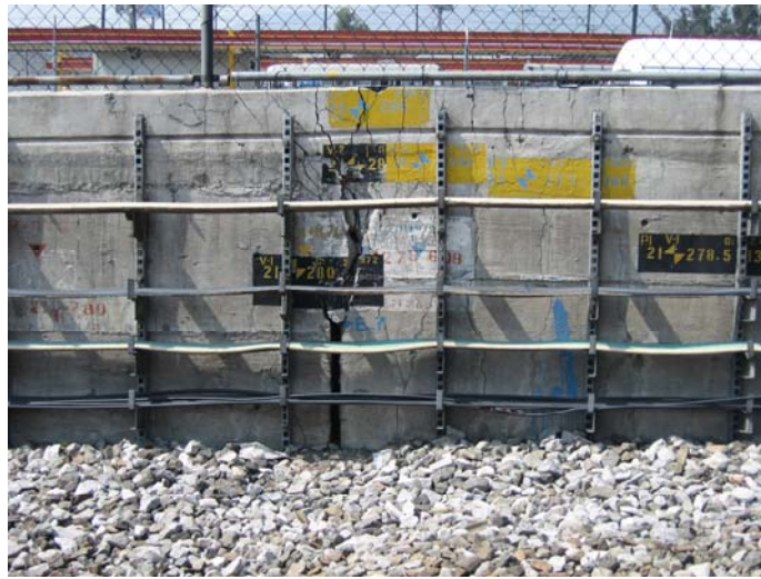
Figura 5.9 Se muestra el aplastamiento del concreto, en los muros laterales, la grieta en la parte inferior evidencia la falla a tensión de la losa, cadenamiento 21+280
