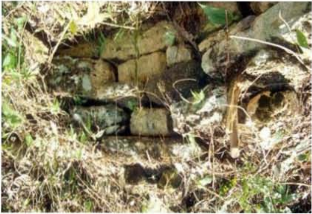
Restos de la pared de la fachada norte de la estructura
