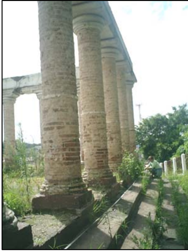
Foto No. 6.30 Obsérvese la eliminación de recubrimiento y los materiales de construcción de las columnas. Fuente: Autor
