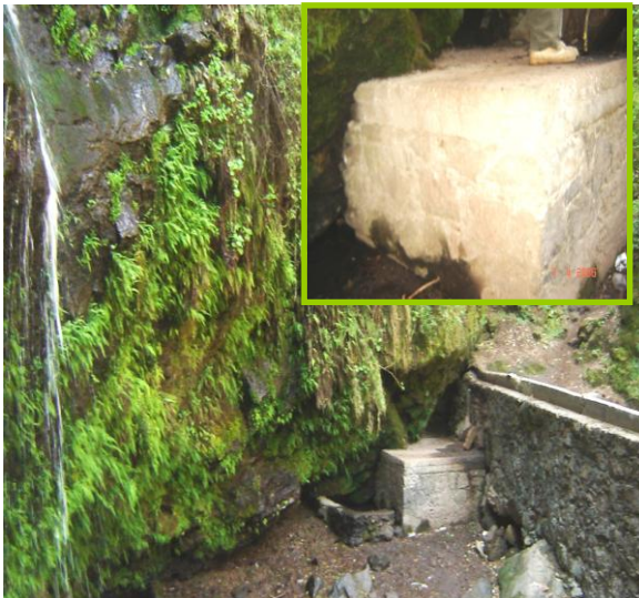
FIGURA 4.38 CAJA DE PROTECCIÓN DEL MANANTIAL
