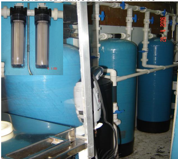
SISTEMA DE FILTROS DE CARBÓN ACTIVADO
