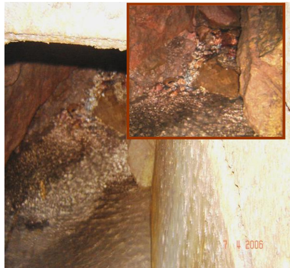
FIGURA 4.39 BROTE DE AGUA AL INTERIOR DE LA CAJA
