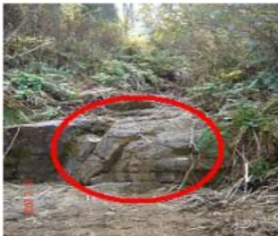
FIGURA 4.9 FUERTE EROSIÓN HÍDRICA
