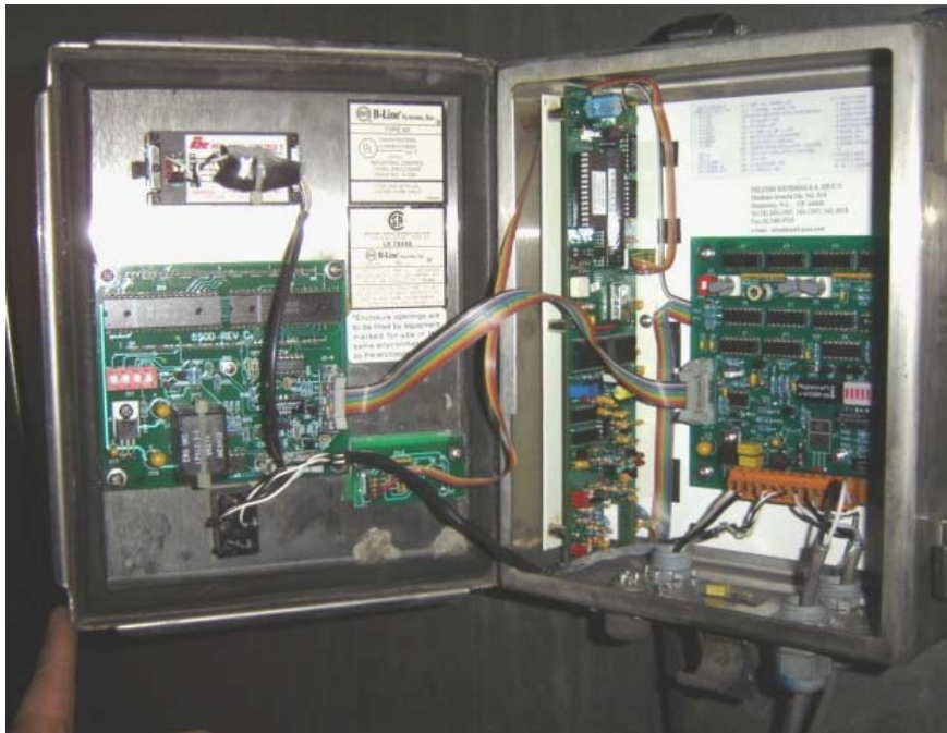
FIGURA 28. INTERIOR DE GABINETE DE TOTALIZADOR T650N MOSTRANDO TARJETA INDICADORA, TARJETA COMPENSADORA Y TARJETA MULTIPLICADORA
