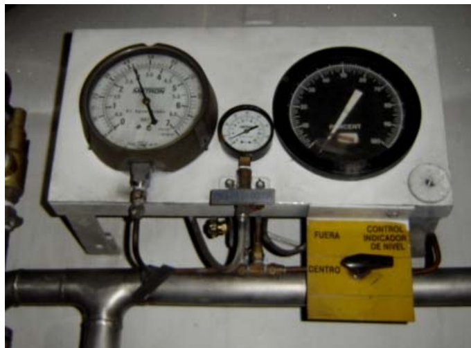
Figura 19. INDICADOR DE NIVEL Y MANÓMETROS
