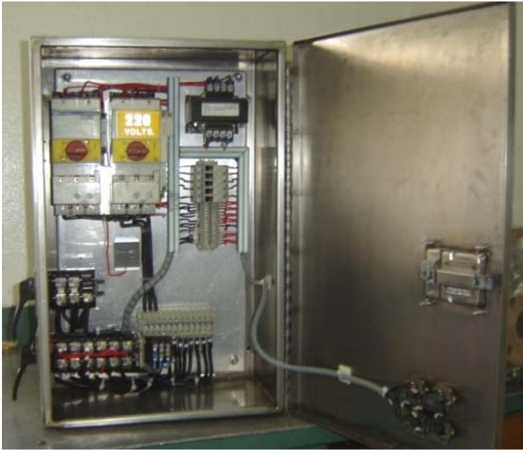
Figura 8. TABLERO ELÉCTRICO DE PIPA CRIOGÉNICA HABILITADO Y LISTO PARA TRABAJAR
