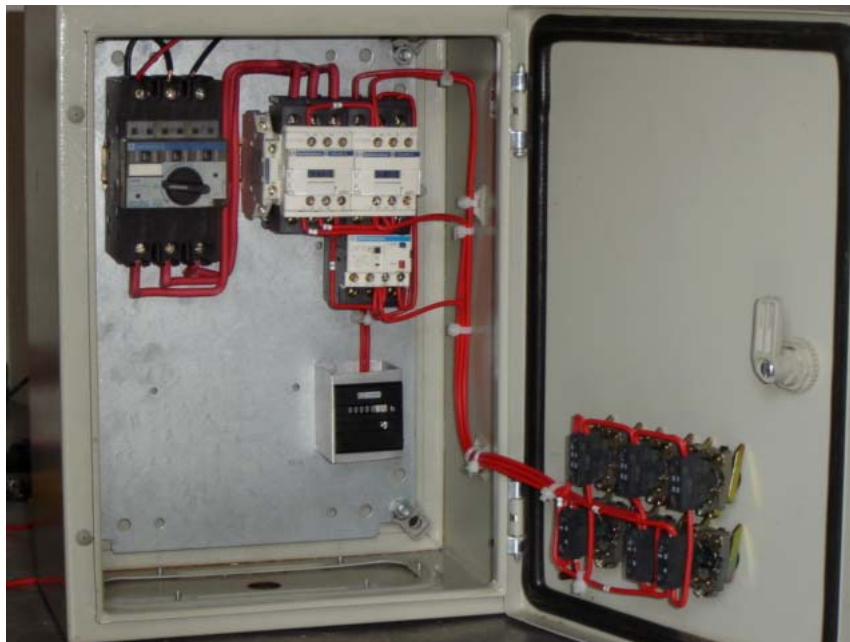
FIGURA 35-b. TABLERO ELÉCTRICO DE FUERZA Y CONTROL DE PIPA DE CO 2 ACTUAL.
