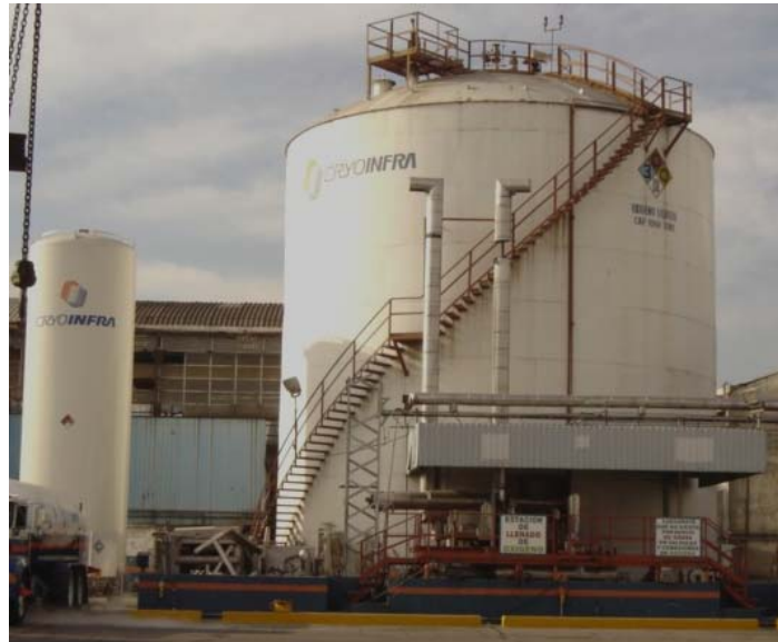
Figura 1. TANQUES PARA ALMACENAMIENTO
