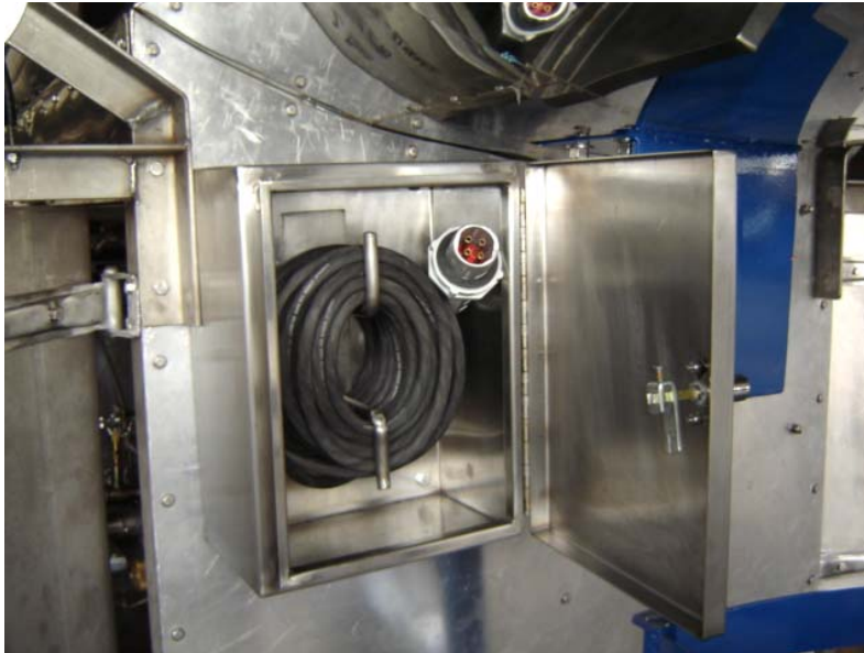
FIGURA 36. GABINETE DE TOMA DE FUERZA
