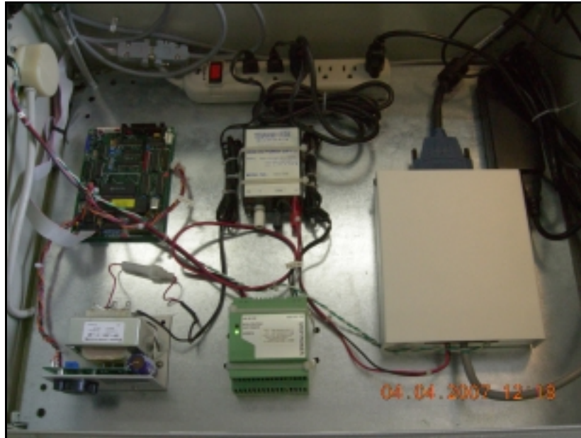
Figura 4.6. Montaje de los módulos de instrumentación dentro del gabinete.
