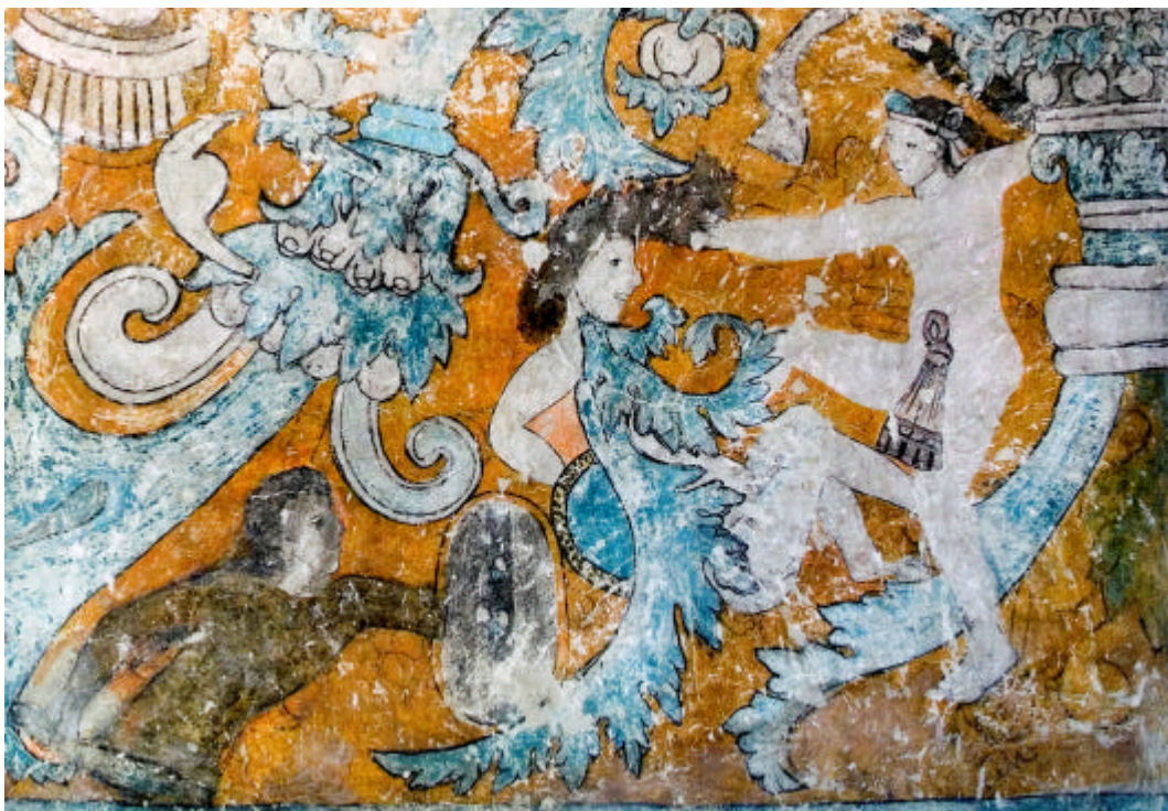
Foto 19. Muro norte sotocoro
