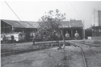
La casa redonda de la Estación Central de Guatemala, presenta deterioro, sin que el concesionario se interese por su restauración, aun cuando hace uso de las instalaciones, año 2005.
