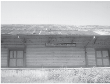
Fachada principal estación de Coatepeque, cubiertas y muros altamente deteriorados, año 2005.
