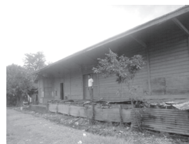
En la actualidad el edificio administrativo de la estación de Mazatenango se encuentra invadido por indigentes, año 2005.
