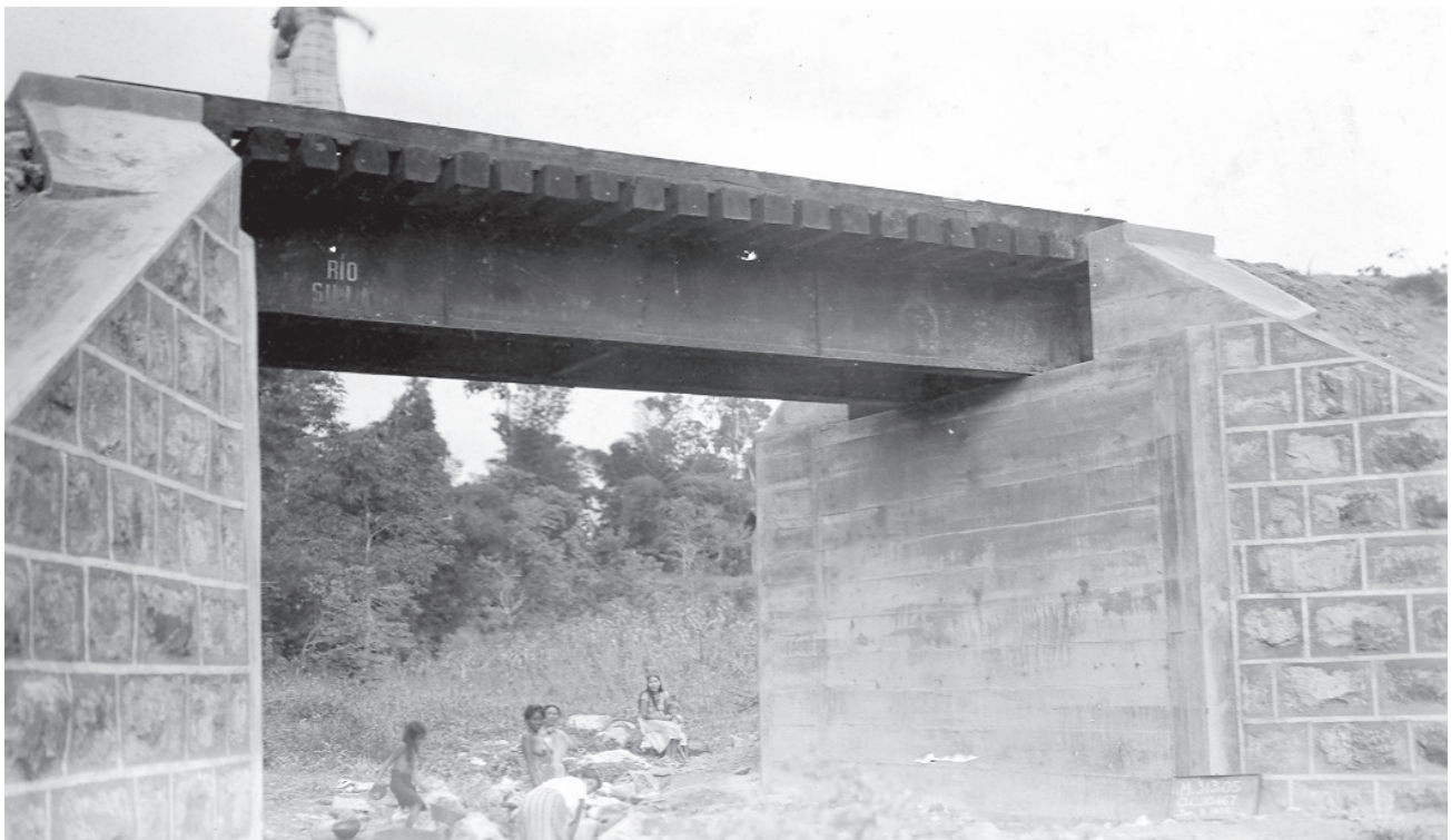
En la construcción de puentes se utilizaron sistemas mixtos que incluían bases de mamposestría, vigas de metal y madera.
