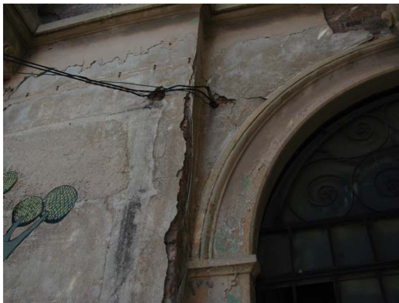
Imagen 21. La falta de mantenimiento y la exposición a los cambios climáticos y la humedad, están provocando la disgregación del material y hasta el desprendimiento del mismo. Foto: A. Contreras, abril 2007.
