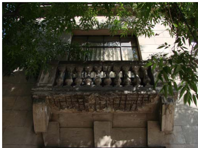
Imagen 16. Se observa en el balcón del inmueble ubicado en la calle de Colima 141, el alto nivel de corrosión en las varillas, a causa de el desprendimiento del concreto. Foto A. Contreras, abril 2007.
