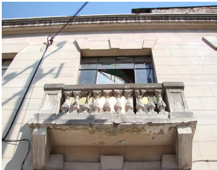
Imagen 17. Al igual que en la imagen 16, el acero ahogado en la losa que forma el balcón esta provocando la corrosión del mismo. Este balcón es del inmueble ubicado en Colima 139. Foto: A. Contreras Abril 2007.
