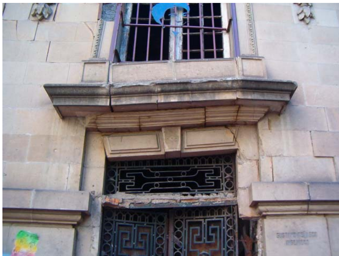
Imagen 20. Las ondas de choque provocadas por el sismo del 85 provocaron que la estructura del inmueble ubicado en la Plaza Río de Janeiro # 46 se colapsara. Foto: Contreras A. Contreras, abril 2006.
