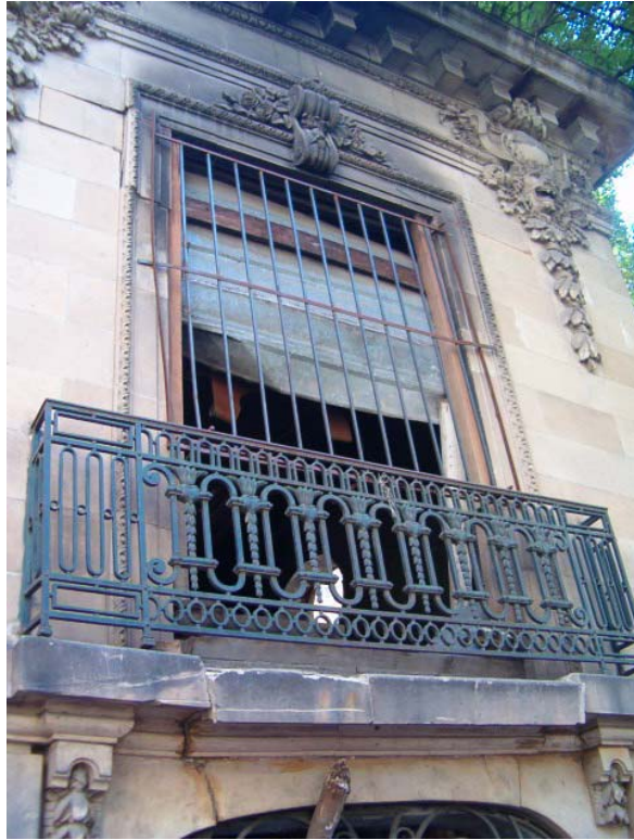
Imagen 70. Se observa en la parte superior del vano, la mancha de humo provocada por el incendio que terminó de colapsar este inmueble. Foto: A. Contreras, abril 2007.
