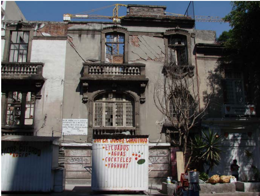
Imagen 62. Inmuebles en estado ruinoso en la calle de Puebla. Foto A. Contreras. Abril 2007.
