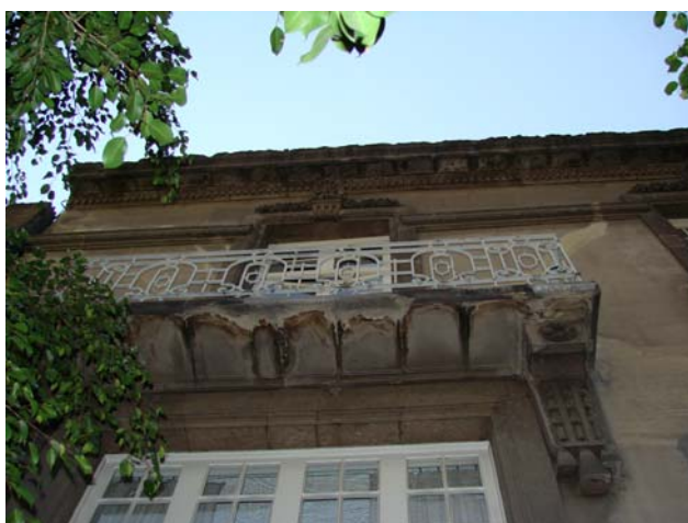
Imagen 15. Se observa en el balcón del inmueble ubicado en la calle de Puebla 114, las manchas de humedad que provocaron la corrosión de las varillas que se encuentran ahogadas en la losa.
