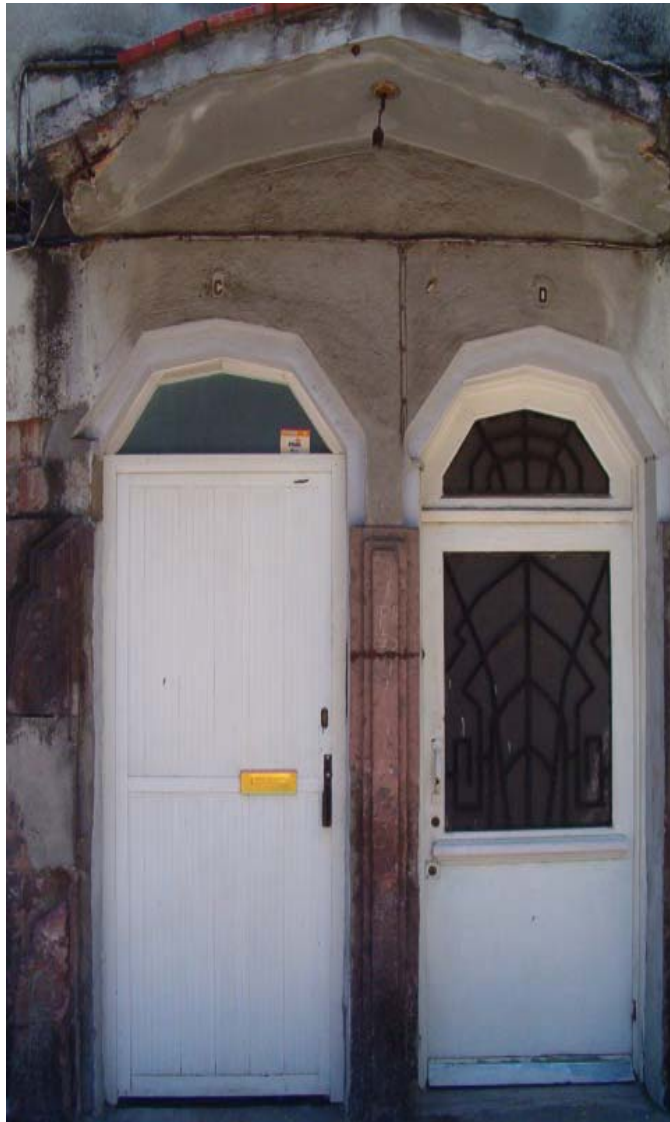
Imagen 18. Inmueble ubicado en la calle de Puebla 78. En donde se observa como en la marquesina se esta desprendiendo el concreto a causa de la humedad. Foto A. Contreras, abril 2006.
