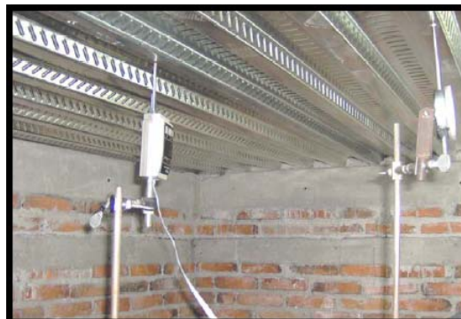
Figura 4.16 Medidores de desplazamiento (micrómetros) ubicados en sitios donde se desea conocer la deflexión producida por la carga
