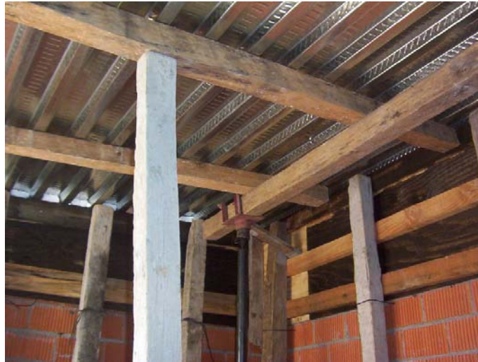
Figura 2.3 Sistema losacero con apuntalamiento debido a los grandes claros.
