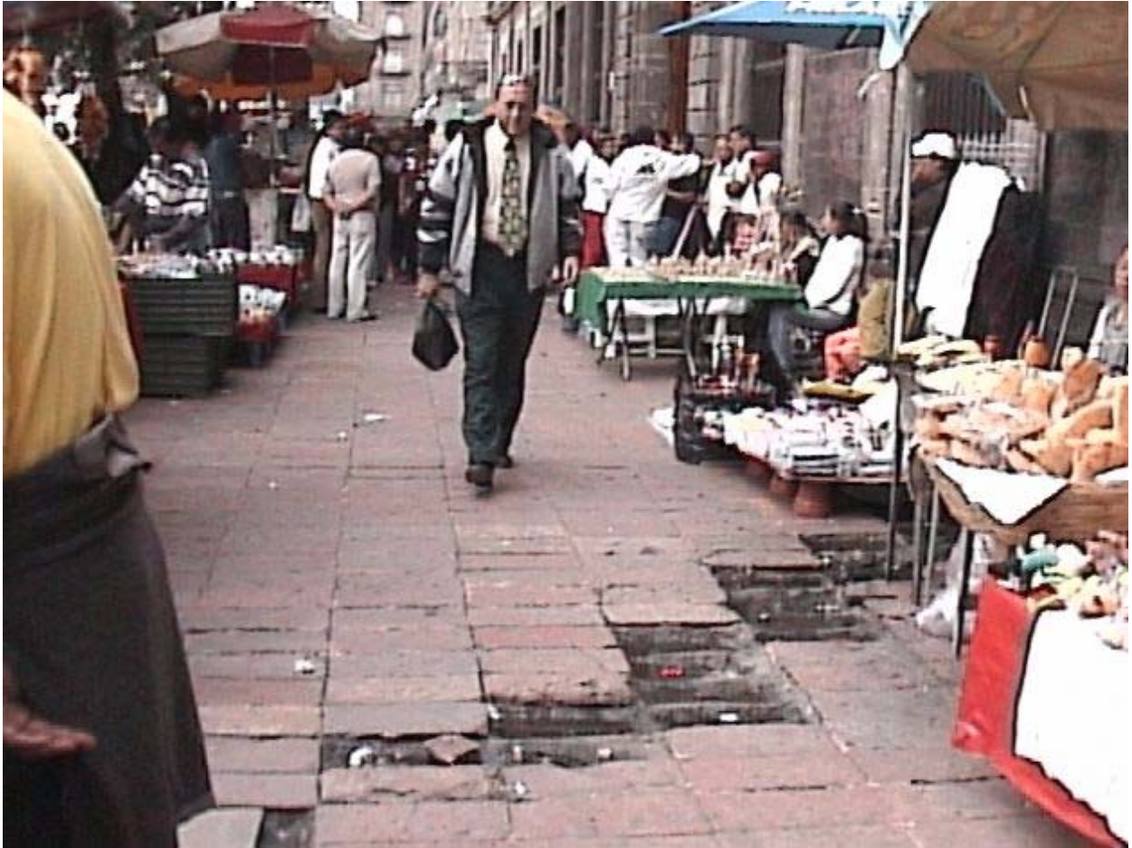
Estado en que se encontraba la calle de Monte de Piedad
