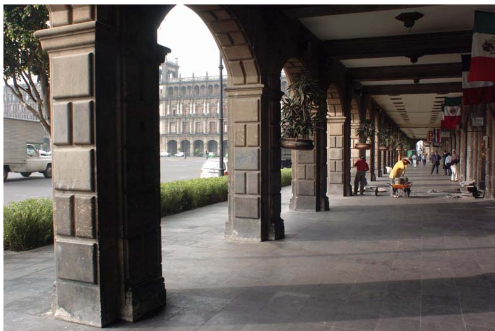
Rehabilitación de la acera de Monte de Piedad y del Portal de Mercaderes.
