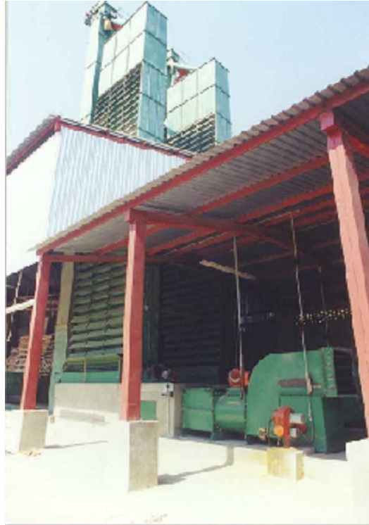
Figura. 1.4. Secador tipo cascada, instalado en la Arrocería de Morelos Sociedad Anónima (ARMOSA), ubicada en Puente de Ixtla Morelos.
