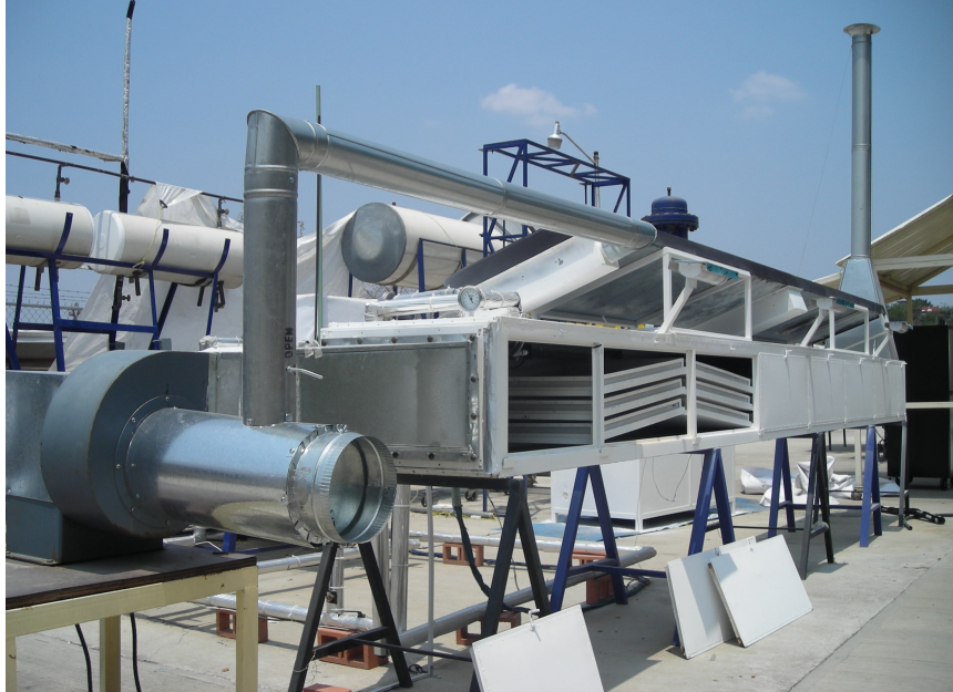
Figura 3.2. Fotografía del túnel de secado ya instalado.
