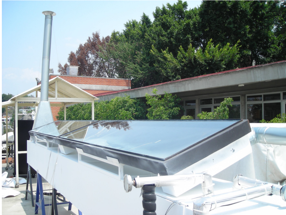
Figura 3.6. Arreglo de calentadores solares de aire.
