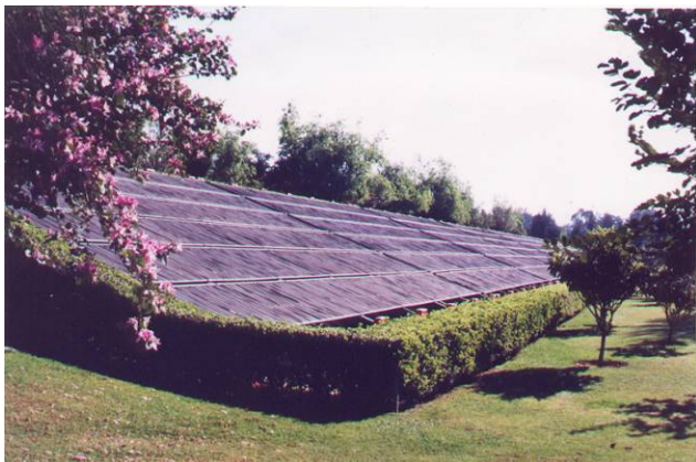
Figura 13.1 Sistema de colectores planos para calentamiento de agua de la alberca de olas del Centro Asturiano. CRZ
