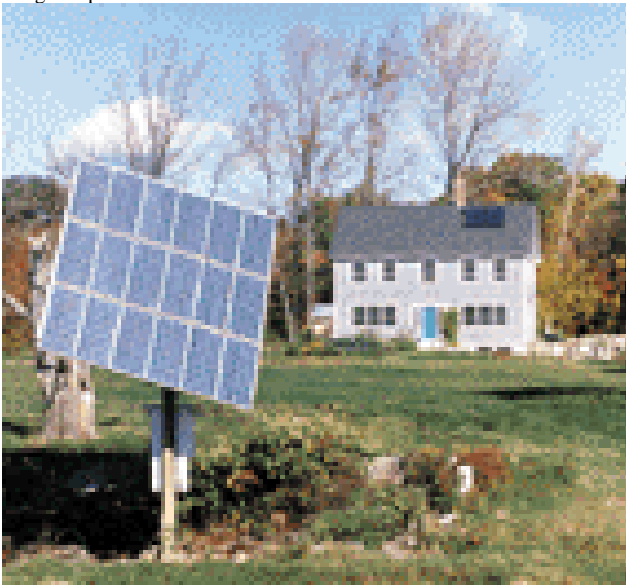
Figura 7.5 Postes y mástiles para sostener los módulos fotovoltaicos. Pueden tener incluidas las baterías y sistemas de seguimiento solar.
