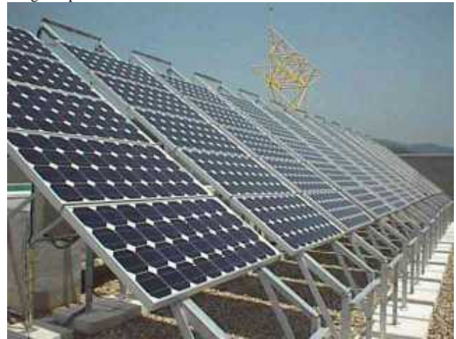
Figura 7.10 Estructuras de soporte para módulos fotovoltaicos.
