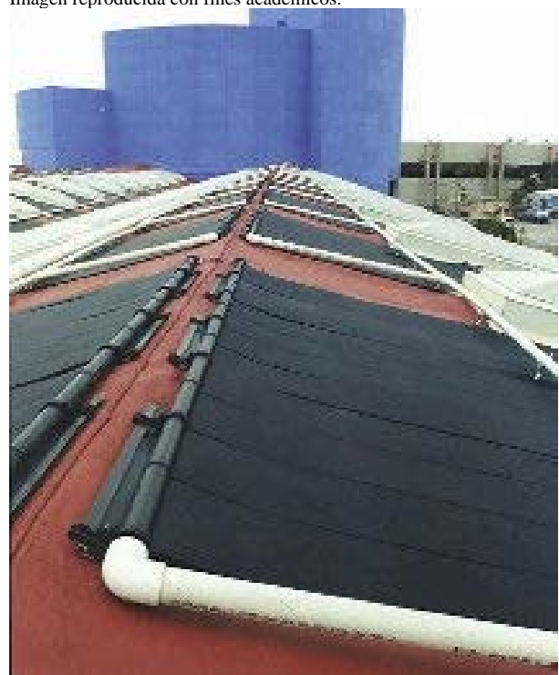
Figura 10.20 Colectores de polipropileno negro para calentamiento de agua de albercas.
