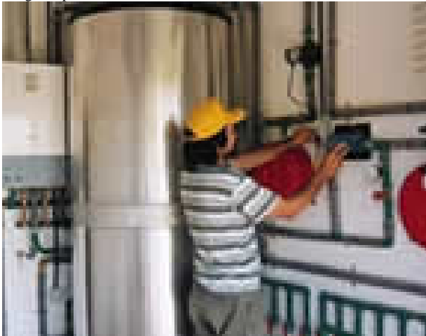
Figura 4-5 Instalaciones de envergadura demandan cierto espacio en sala de máquinas.
