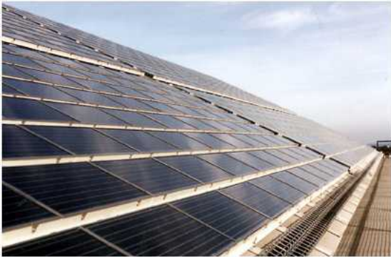
Figura 7.3 Panel de módulos fotovoltaicos.
