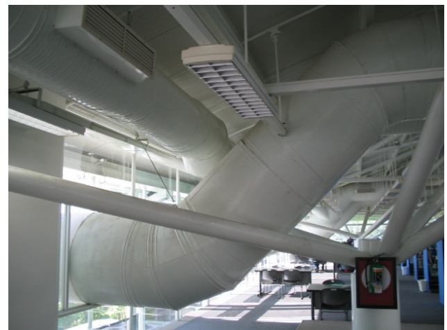
Figura A.4 Troncales de Acondicionamiento de Aire de la USBI. CRZ
