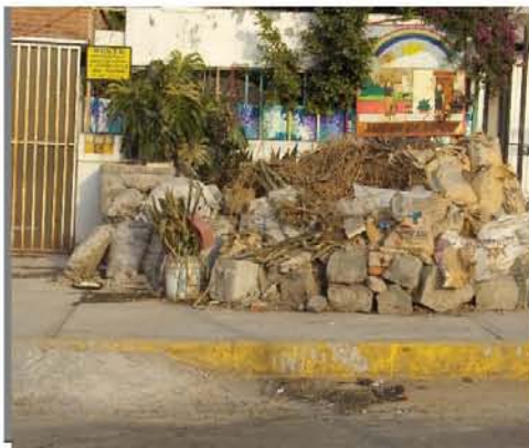
Figura 3.8 Remodelación a pequeña escala
