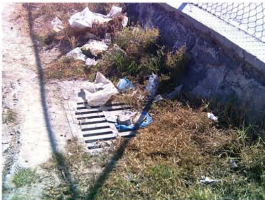
Figura 3.19 Cárcamo de Bombeo
