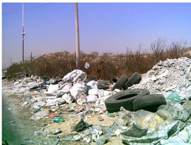
Figura 1.2 Residuos de la construcción y demolición dispuestos sobre la vía pública
