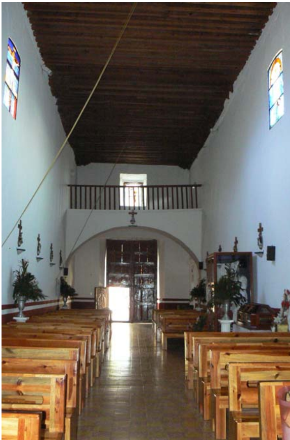
En el interior del templo se aprecia el pequeño coro, con una cubierta de madera del llamado entrepiso franciscano, el cual tiene una cubierta superior a dos aguas recubierto con tejas.
