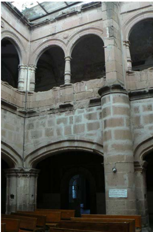
Interior del claustro del exconvento de Copándaro, convento realizado a principios de la segunda mitad del siglo XVI. En ella se puede apreciar la magnífica factura que tuvo en su época de oro, ahora ya bastante dañado. Así mismo podemos observar el agregado al cual ha sido sometido el monumento con la cubierta que cubre el patio del claustro.
