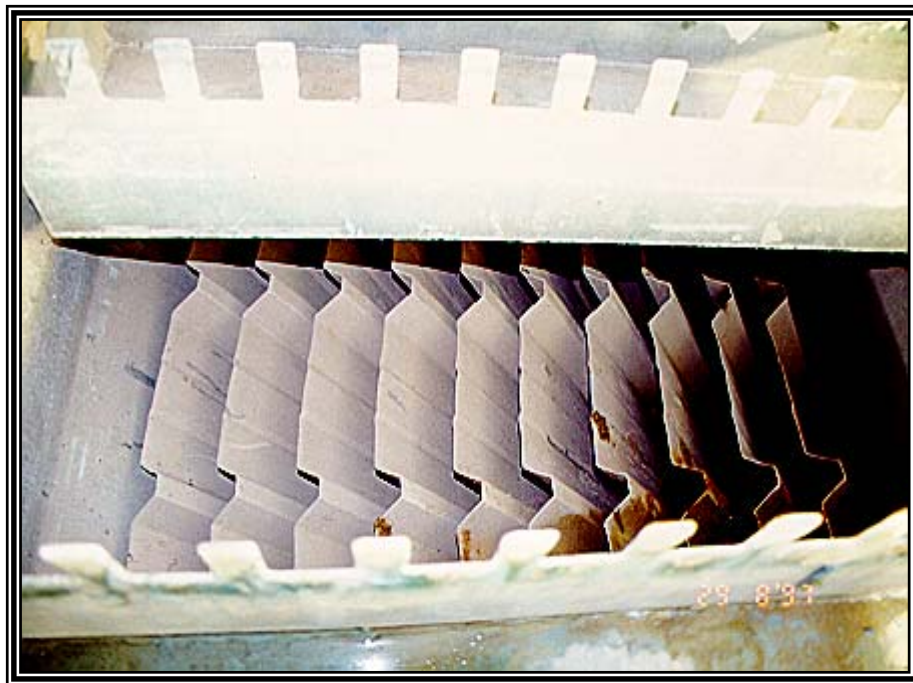
Figura 3.4. SEDIMENTADOR DE PLACAS
