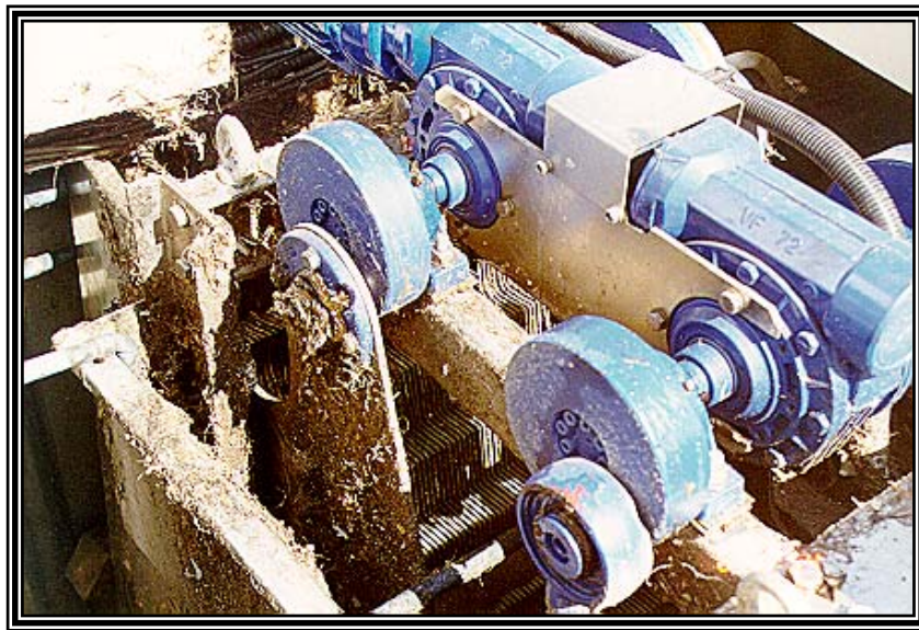
Figura 3.2. REJILLAS PARA LA RETENCIÓN DE SÓLIDOS
