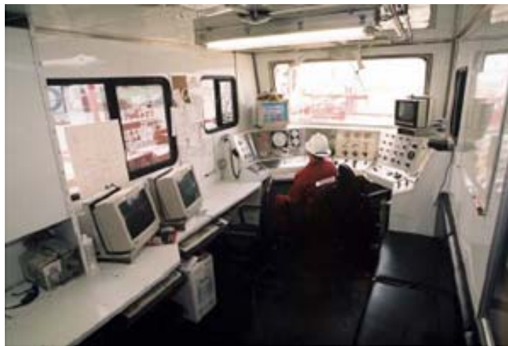
Figura IV.19. Cuarto de Control Nowsco (BJ). 2
