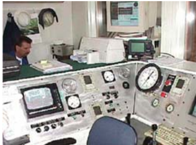
Figura IV.28. Cuarto de Control para Operaciones de Equipo. 2
