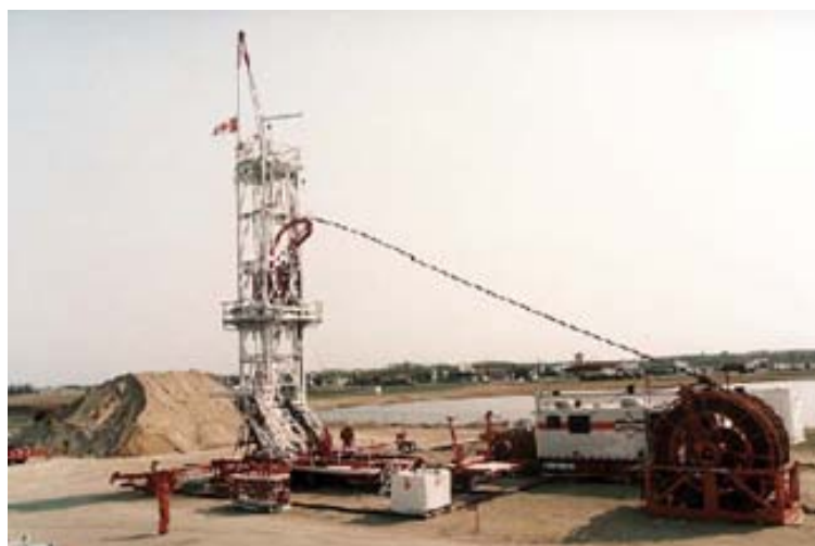
Figura IV.20. Vista completa del equipo No. 2 Nowsco (BJ). 2
