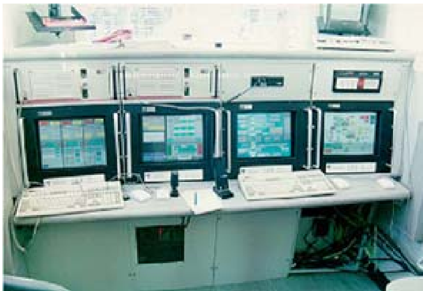
Figura IV.36. Consola de control de Copérnico . 2
