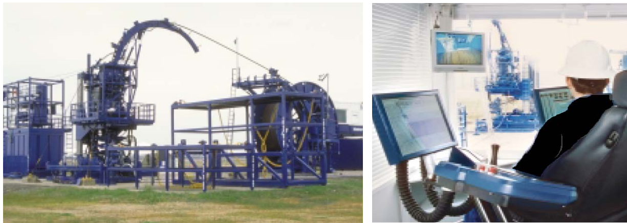
Figura VI.4. Unidad de TF y Control del Sistema. Un sistema cibernético, instalado en la cabina de la unidad CT SEAS, opera el carrete, el cabezal del inyector, el equipo de control del pozo, los estranguladores del control de flujo, las temblorinas para el lodo y las bombas. 17
