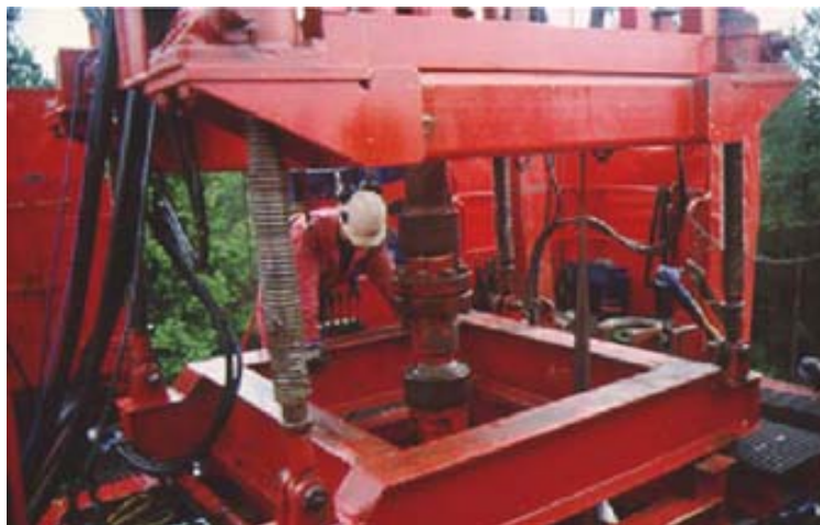
Figura IV.15. Inyector del Equipo Aleman Nowsco. 2
