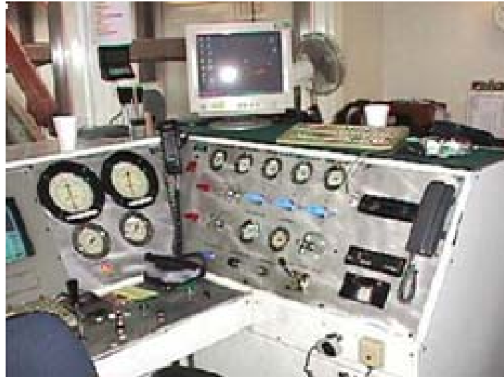
Figura IV.27. Cuarto de Control para Operaciones con T.F. 2
