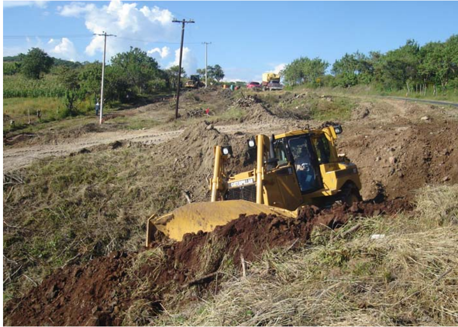
FIGURA 4.9 ADEMÁS DE DESPALME, LOS TRACTORES TAMBIÉN SE USAN PARA LA FORMACIÓN DE LAS TERRACERÍAS TANTO EN CORTES COMO EN TERRAPLENES.
