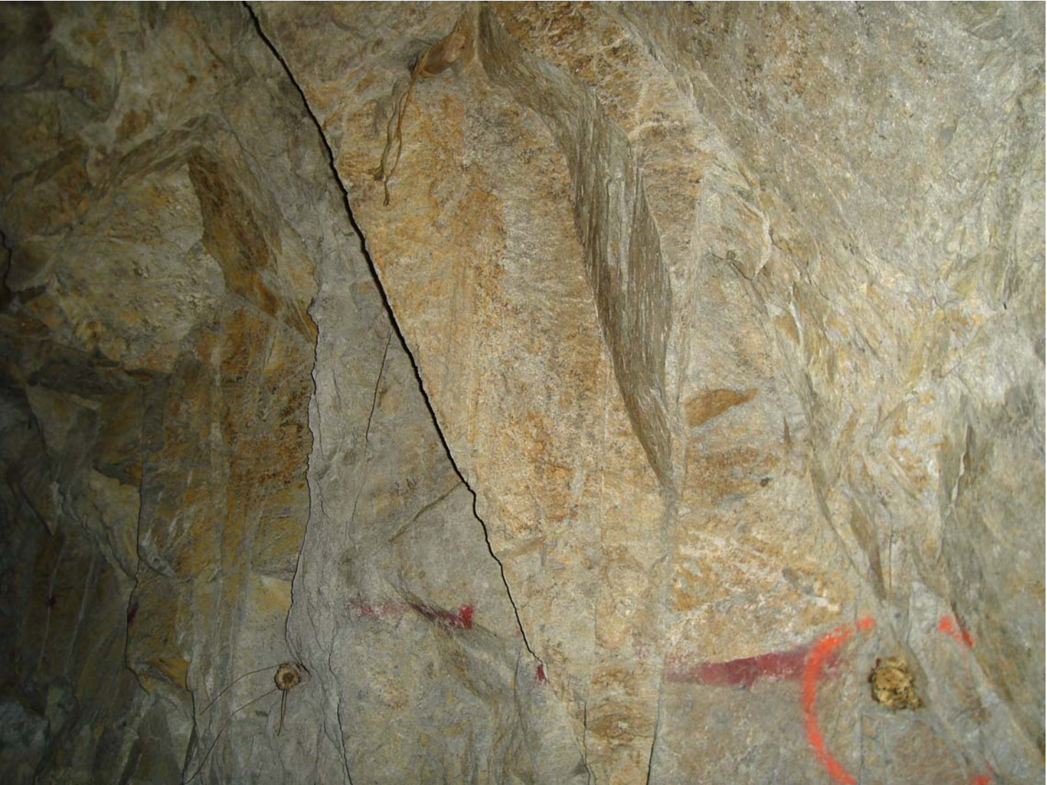
FIGURA 2.20 INTERIOR DEL SOCAVÓN. YA CUENTA CON VARILLAS PARA ESTABILIZAR EL CORTE
