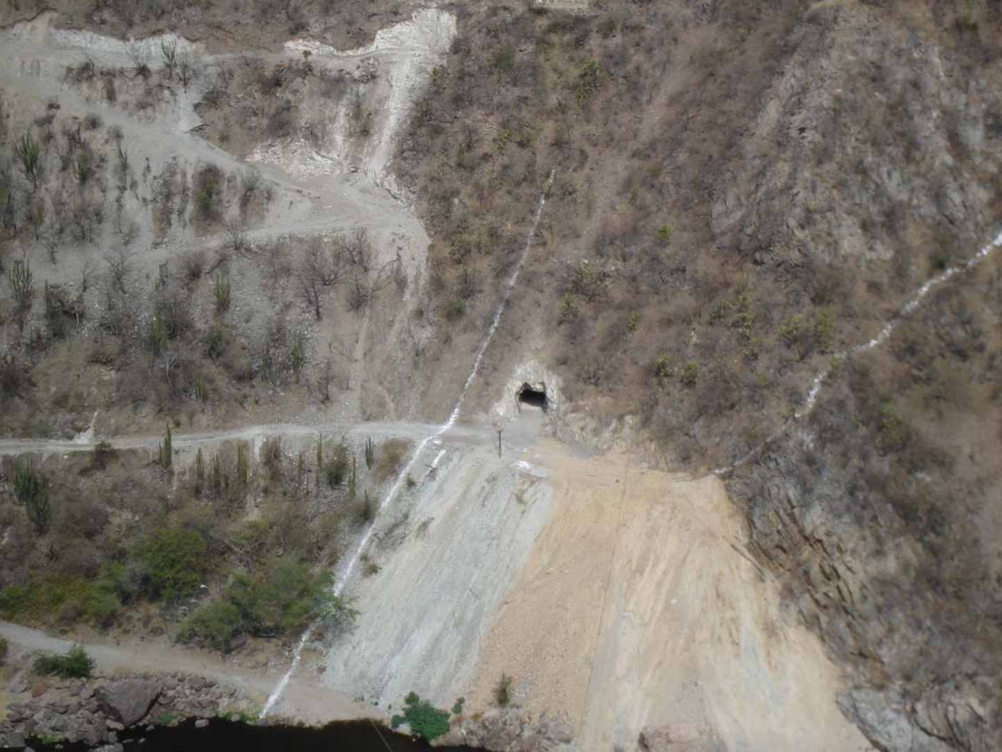
FIGURA 2.18 SOCAVÓN EN LA MARGEN DERECHA DEL RÍO SANTIAGO
