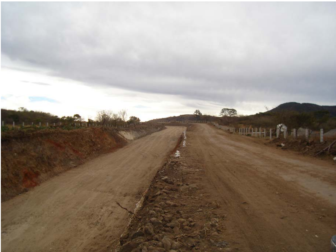
FIGURA 4.8 DURANTE LA CONSTRUCCIÓN DEL CAMINO ES NECESARIO QUE EXISTA UNA VÍA CONSTANTE DE PASO TANTO PARA EL CONTRATISTA, LA CFE Y TERCEROS.
