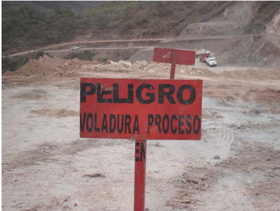
FIGURA 4.16 LA SEGURIDAD DE LOS TRABAJADORES Y DE TODO EL PERSONAL ES PRIMORDIAL POR LO QUE SE COLOCAN ESTOS LETREROS DE "PELIGRO" Y SE HACE SONAR UNA ALARMA DESDE VARIOS MINUTOS ANTES DE LA VOLADURA PARA ADVERTIR A TODA PERSONA CERCANA QUE SE ALEJE
