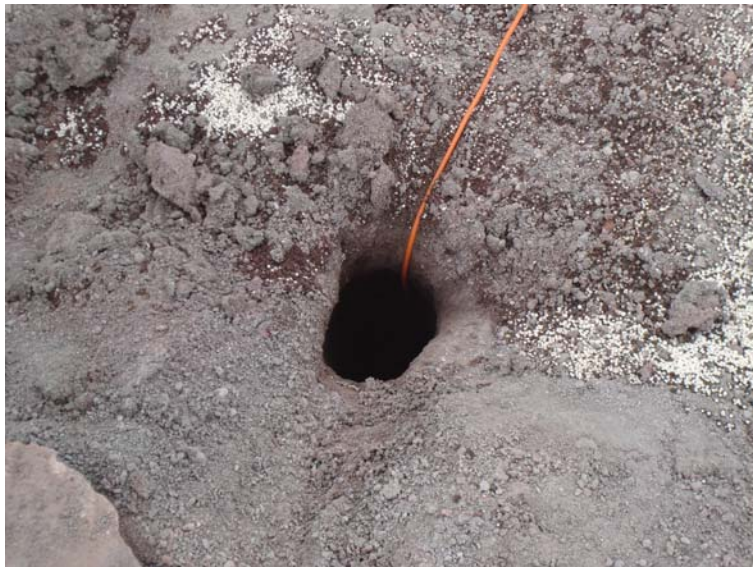
FIGURA 4.13 COLOCACIÓN SE LOS EXPLOSIVOS EN SUS RESPECTIVOS BARRENOS CONECTADOS A LA LÍNEA DE EXPLOSIÓN.
