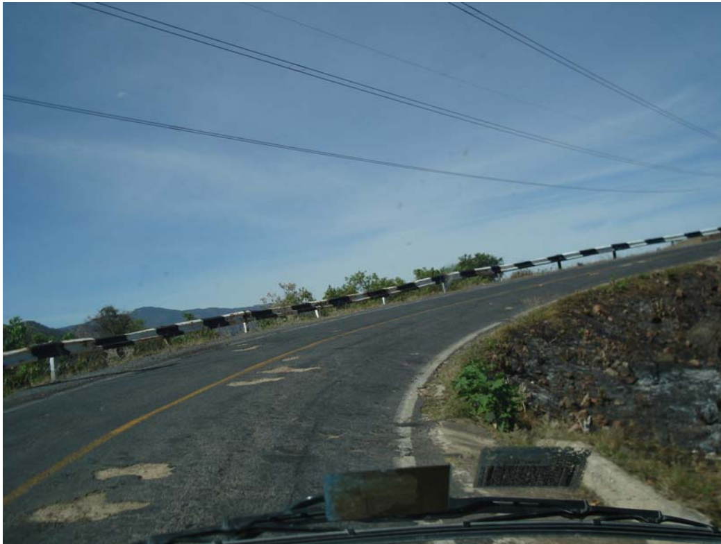
FIGURA 3.6 ESTADO ACTUAL DE LA CARRETERA A HOSTOTIPAQUILLO
