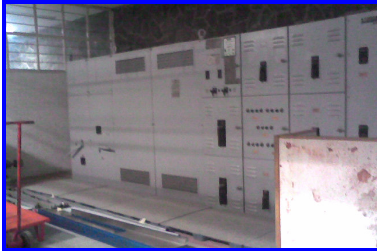
Fotografía 1. Subestación tipo compacta ubicada dentro de la Facultad de Ingeniería.
