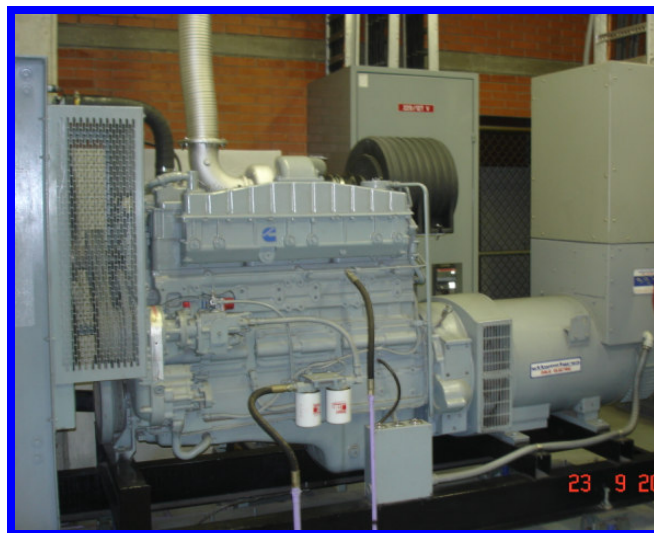
Fotografía 12. Se puede apreciar una planta de emergencia y al fondo su tablero de Transferencia de subestación ubicada en el instituto de Geofísica.
