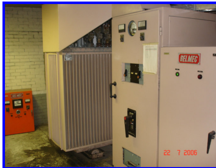
Fotografía 2. Transformador de 500 kVA instalado en el Instituto de Investigaciones Biomédicas I
