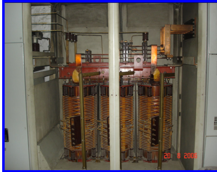
Fotografía 3. Transformador de 300 kVA ubicado en la Facultad de Arquitectura
