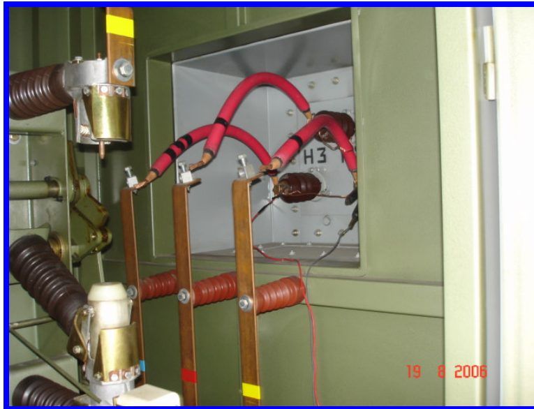
Fotografía 11. Sección de acoplamiento de Subestación – Transformador
