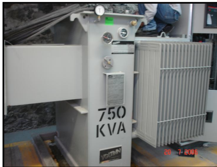
FIGURA 3.1 TRANSFORMADOR "FACULTAD DE MEDICINA".
