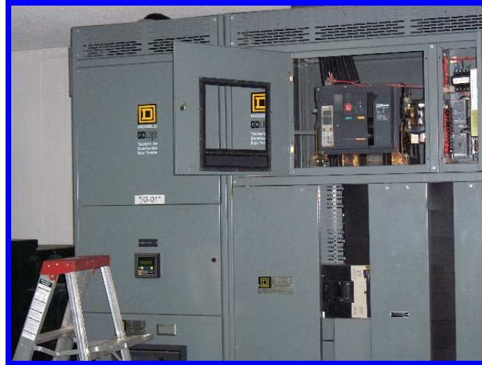
Fotografía 13. Tablero de distribución con interruptor electromagnético.
