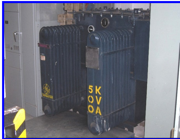
Fotografía 4. Transformador de 500 kVA ubicado en el Instituto de Geografía
