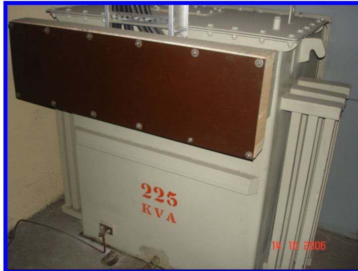
Fotografía 9. Transformador de 225 kVA ubicado en la Facultad de Veterinaria II.
