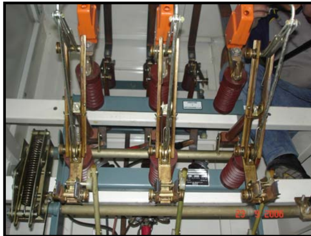
FIGURA 2.8 INTERRUPTOR INSTALADO EN EL INSTITUTO DE GEOLOGÍA, PLANTA HOMOGENIZADORA.
