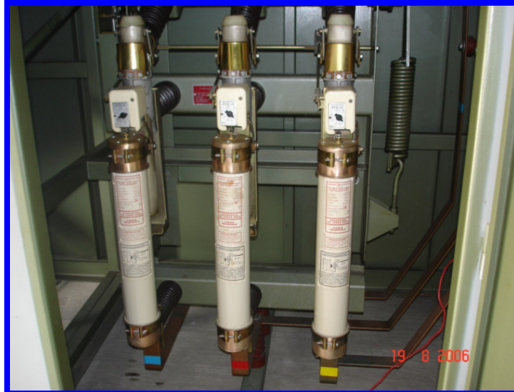
Fotografía 10. Interruptor trifásico con fusibles y cuchillas seccionadoras dentro de una subestación compacta.
