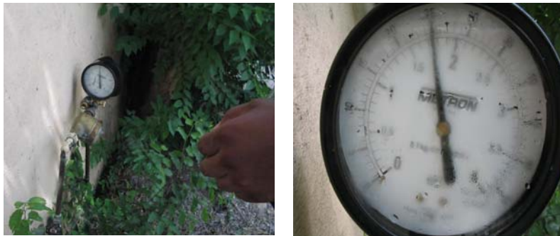
Figura 3.15. Toma de presión en toma domiciliaria doméstica de 1/2".
