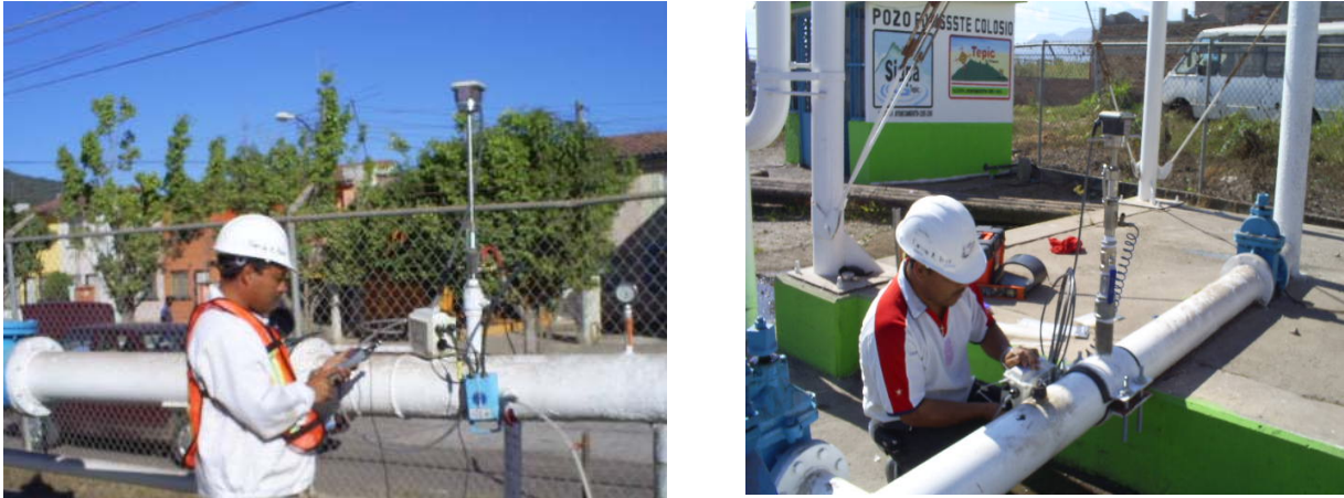
Figura 3.5. Instalación y configuración del Medidor electromagnético de inserción y un registrador tipo Log-Log, en tubería de 8" a la salida del Pozo "Fovisste Colosio" y en la tubería de acero de 6" \phi a la salida del tanque Lagos del Country.
